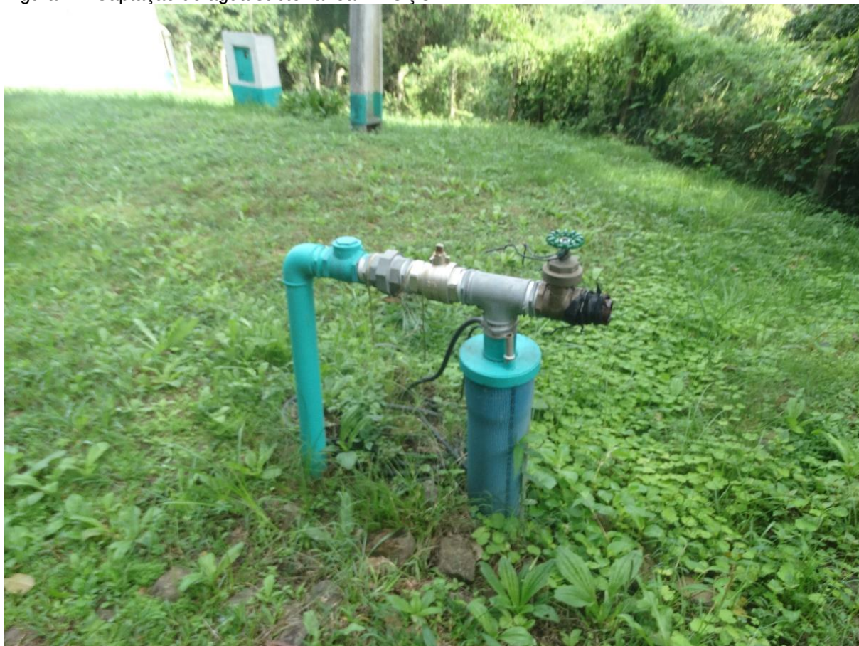
Figura 22: Captação de água subterrânea – POÇO II
