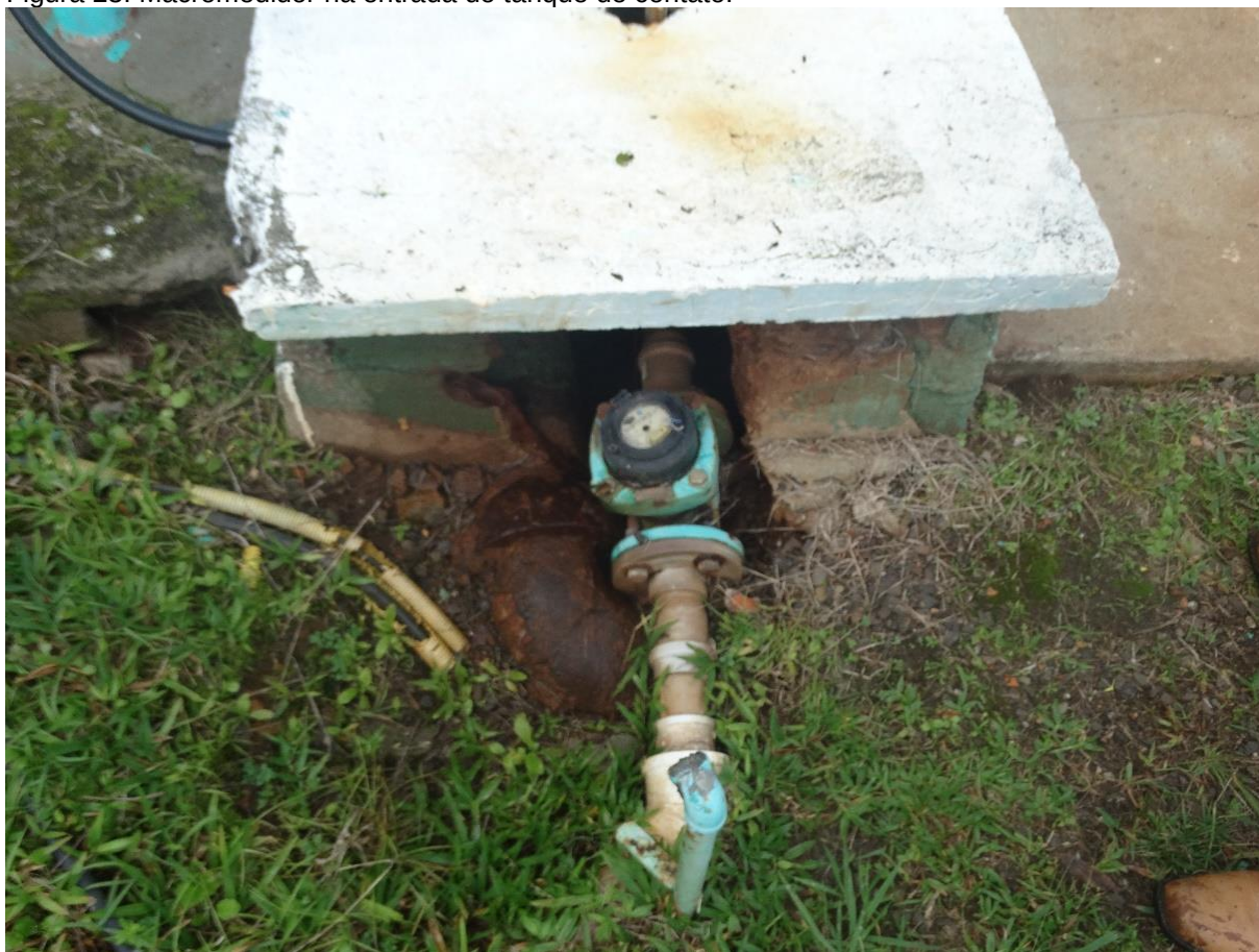
Figura 23: Macromedidor na entrada do tanque de contato.
