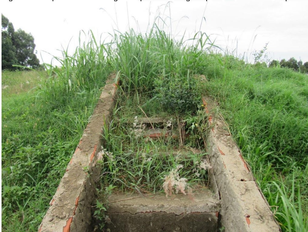
Figura 53: Dispositivo de drenagem superficial de águas pluviais sem manutenção adequada.
