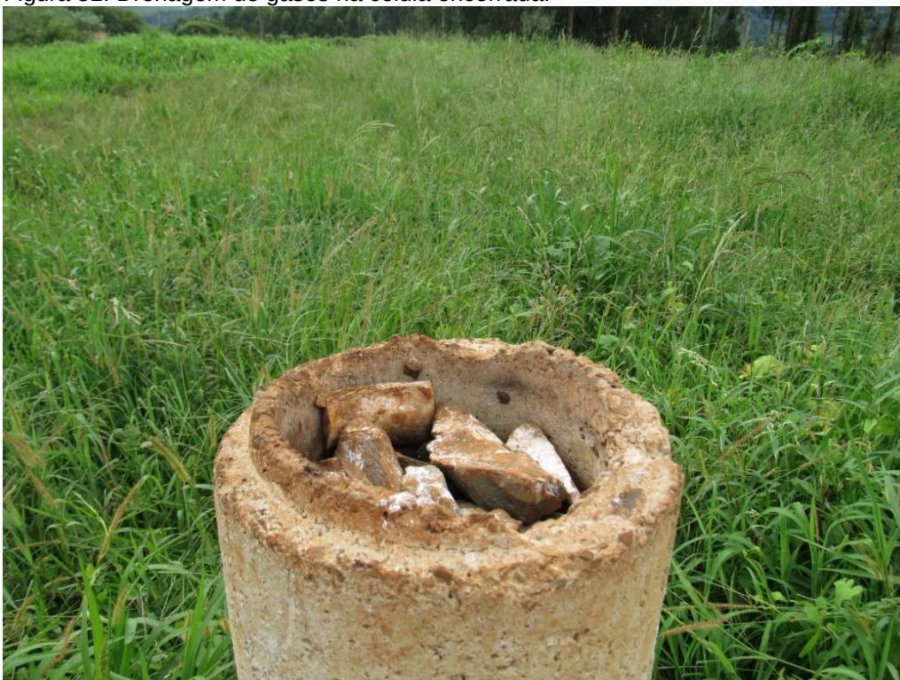
Figura 51: Drenagem de gases na célula encerrada.
