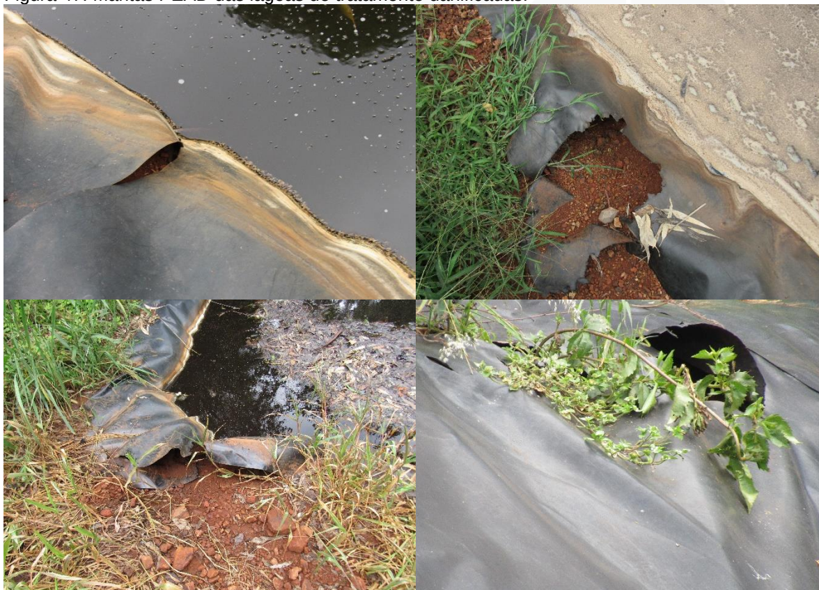
Figura 47: Mantas PEAD das lagoas de tratamento danificadas.
