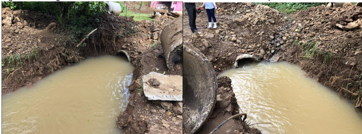
Figura 75 - Imagens da Área Problema 05 – Rua Vereador Silvio Santo Triques.
