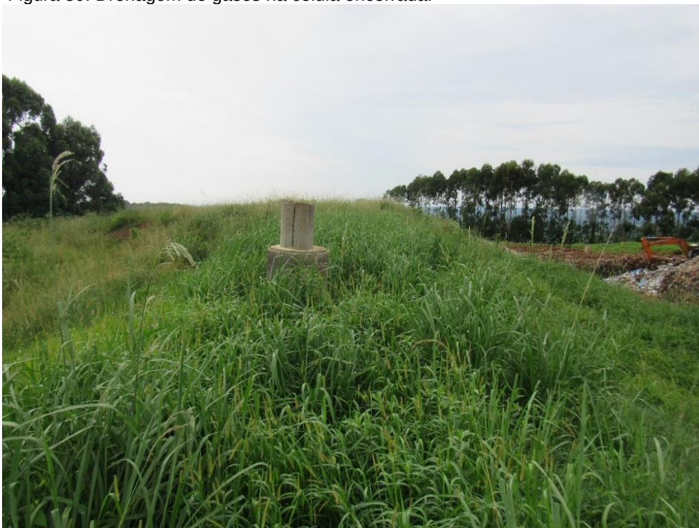
Figura 50: Drenagem de gases na célula encerrada.
