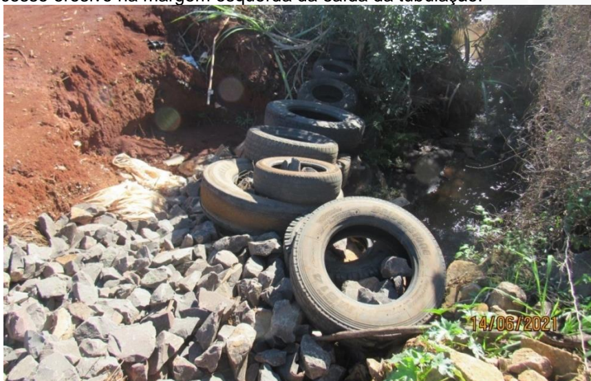
Figura 20: Processo erosivo na margem esquerda da saída da tubulação.
