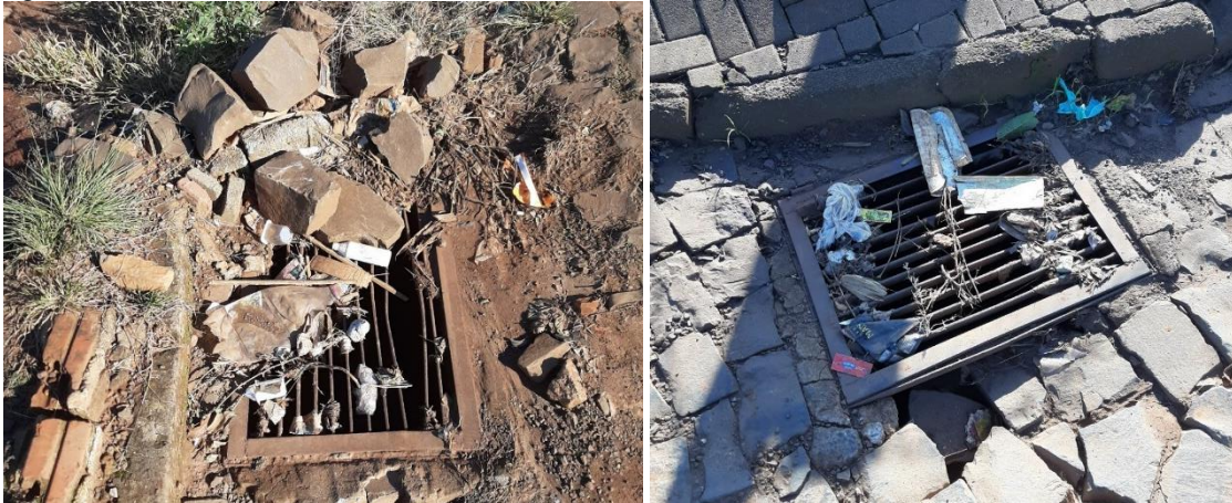
Figura 16: Boca de lobo parcialmente obstruída.
