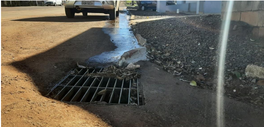
Figura 23: Boca de lobo mal posicionada.
