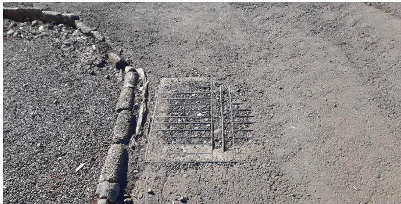
Figura 15: Boca de lobo obstruída.
