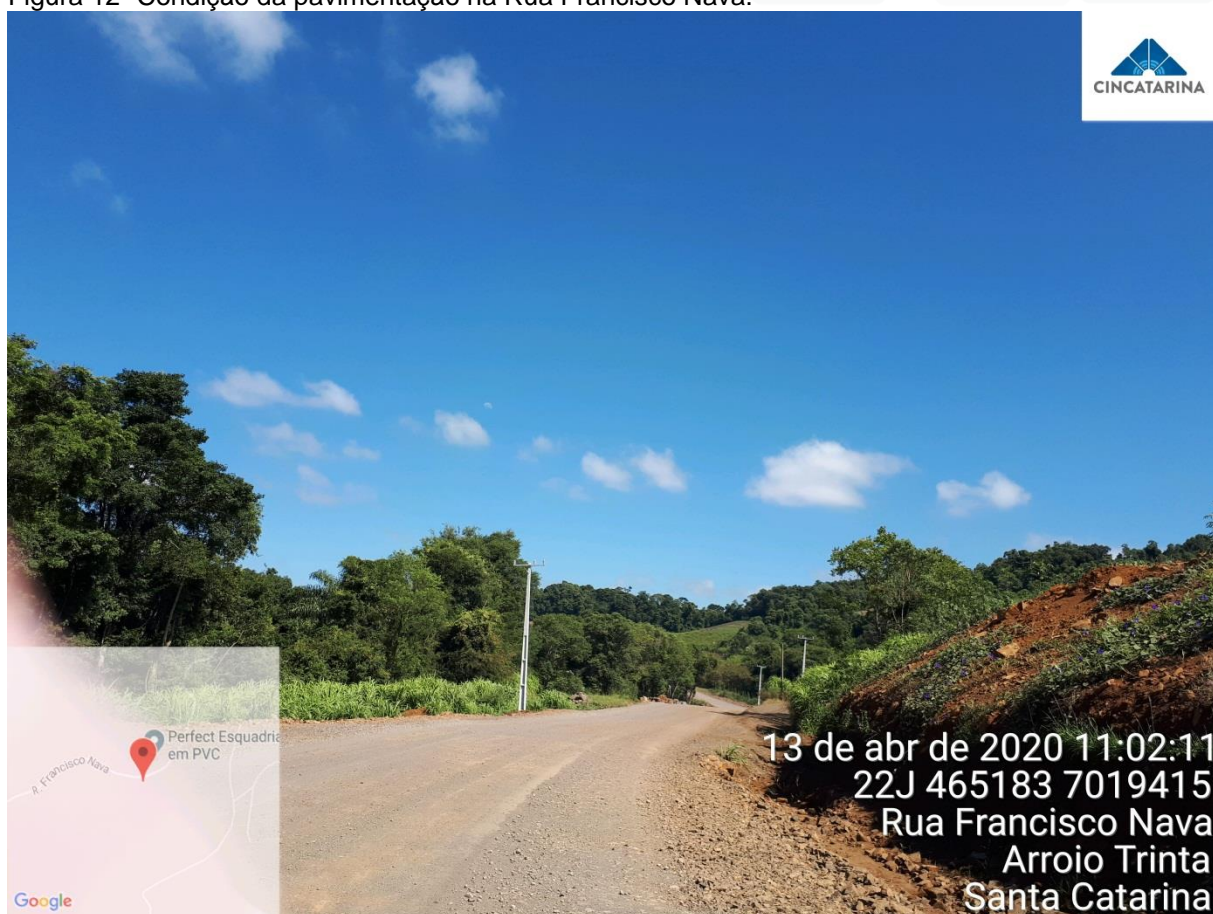
Figura 12- Condição da pavimentação na Rua Francisco Nava.
