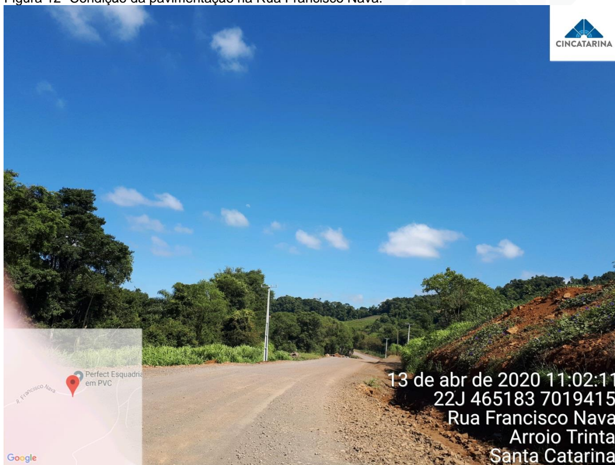
Figura 12- Condição da pavimentação na Rua Francisco Nava.
