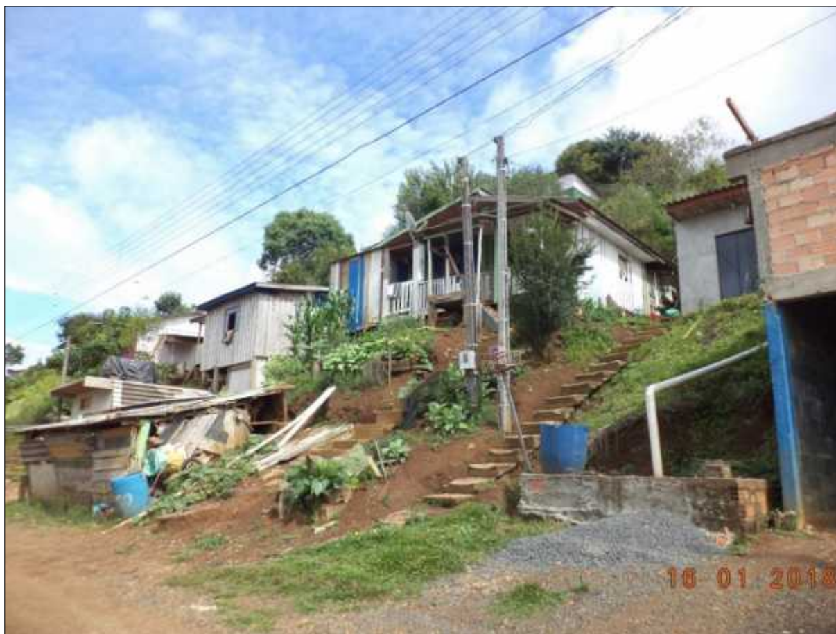
Figura 46 - Casa construída de forma precária, no ponto RG08. Essa construção torna a área a sua volta como de alto risco.
