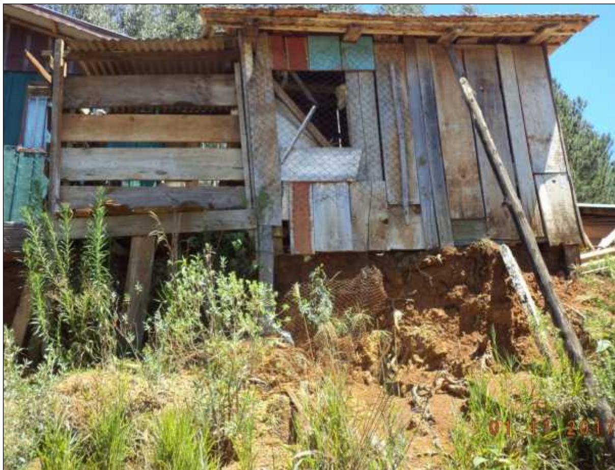
Figura 36 - Galpão localizado na borda do talude, ponto RG01, que apresenta sinais de instabilidade.
