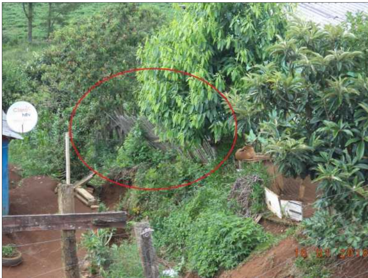
Figura 48 - Muro inclinado localizado na margem deste canal de drenagem, no ponto RG09
