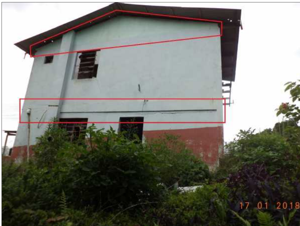
Figura 41 - Residência localizada no bairro São Sebastião, no ponto RG04. Grifado em vermelho estão as rachaduras.
