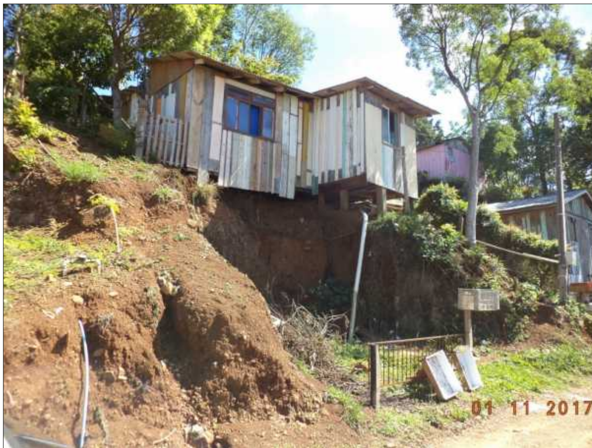
Figura 51 - Residência em área de risco, ponto RG12, localizada no bairro N. Sra. Aparecida.
