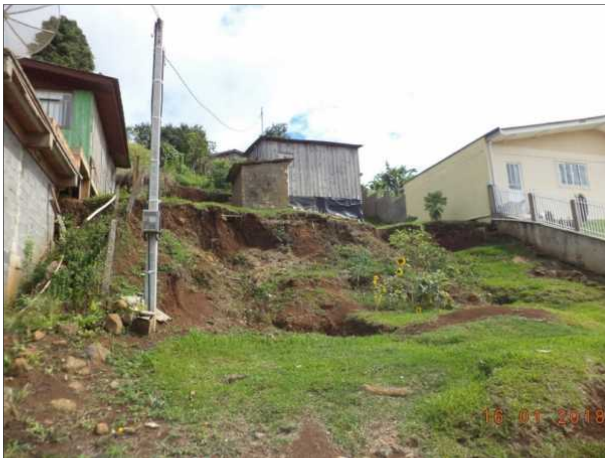
Figura 45 - As construções localizadas no ponto RG07 encontram-se muito próximas à beira do talude. Esse terreno passou por intensos processos de erosão.
