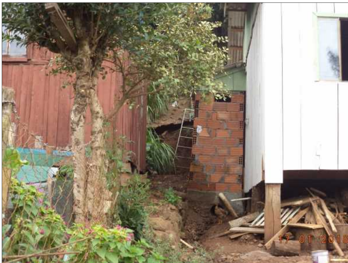
Figura 38 - Calha por onde escoar a água da rodovia, ponto RG02. Vê-se que ela está quebrada e sua base encontra-se erodida. Todo o seu fluxo escoar por entre essas duas residências.
