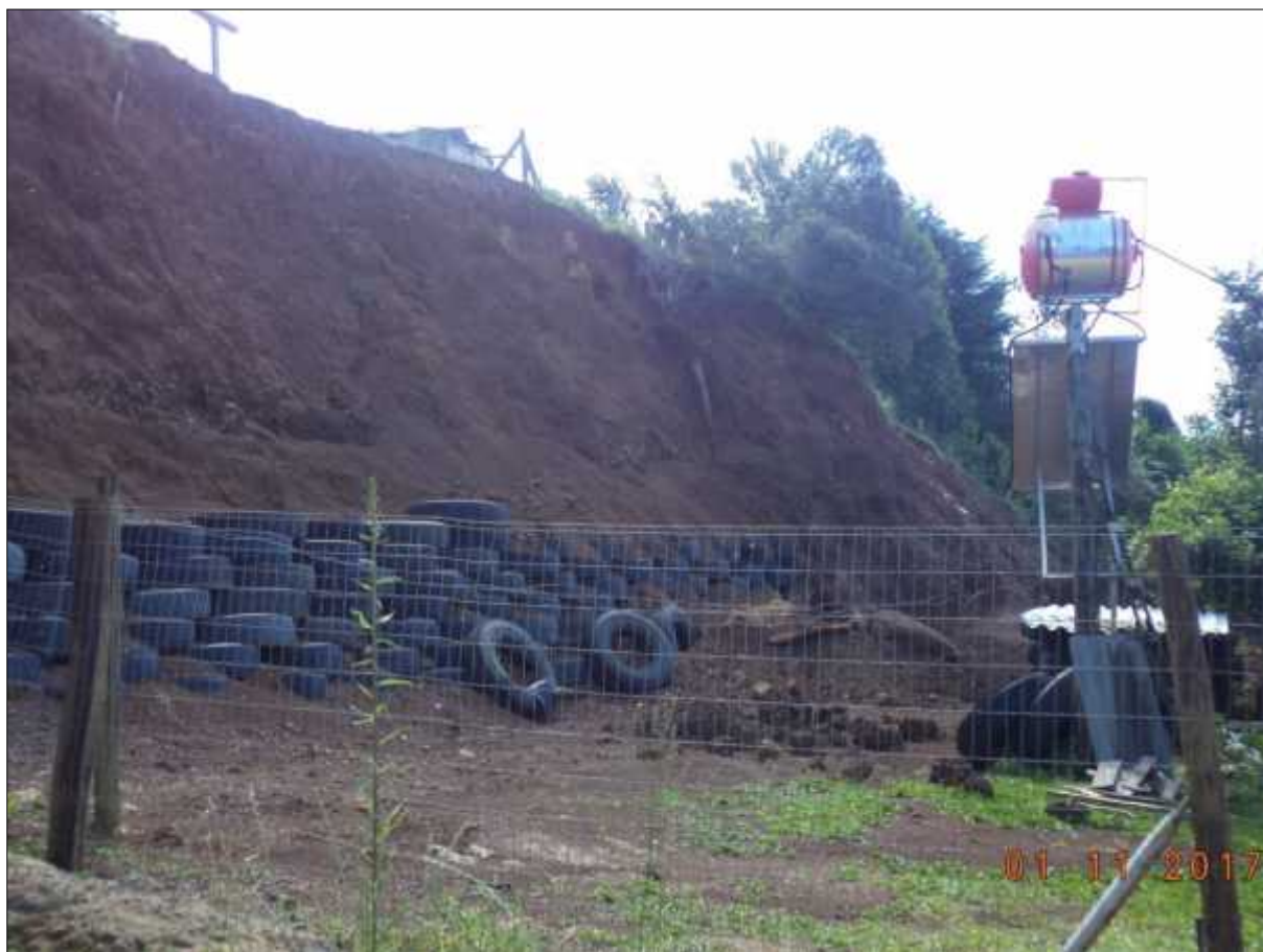
Figura 56 - Muro de contenção rompido localizado em área de risco, no ponto RG16 no bairro São Miguel.
