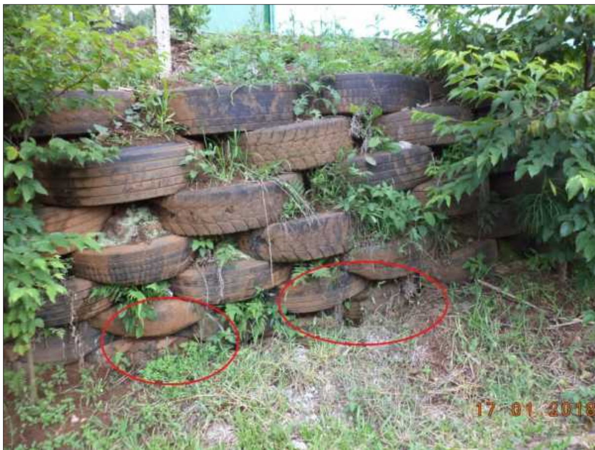
Figura 39 - Água minando na base deste muro, indicando que existe fluxo de água no interior da encosta.
