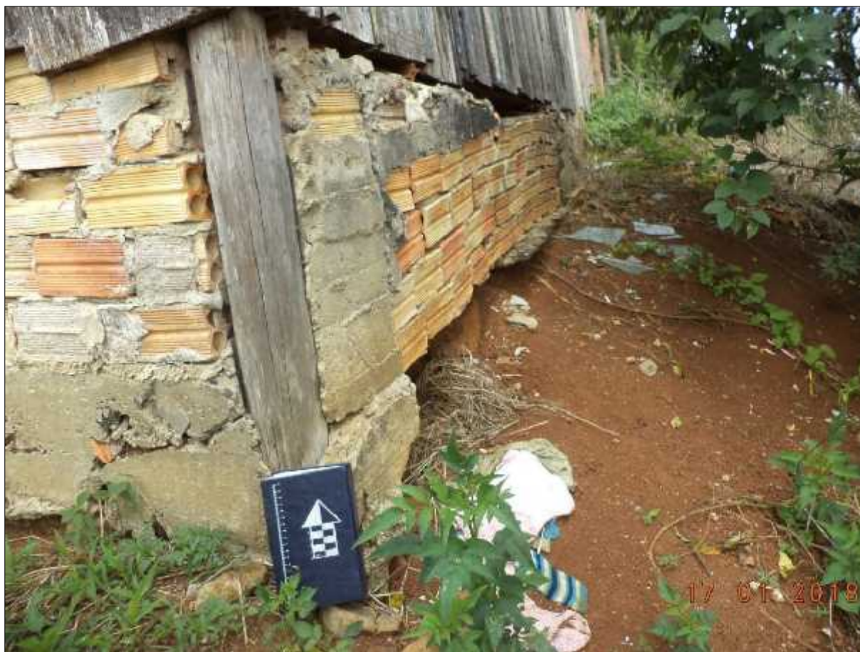
Figura 62 - Construção localizada no ponto RG21. Vê-se que o solo foi erodido em baixo dela, sua parede está rachada e embarrigada
