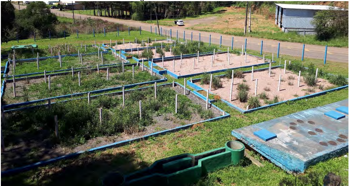
Figura 170: Estação de tratamento de esgoto Liberata – 10/2022.
