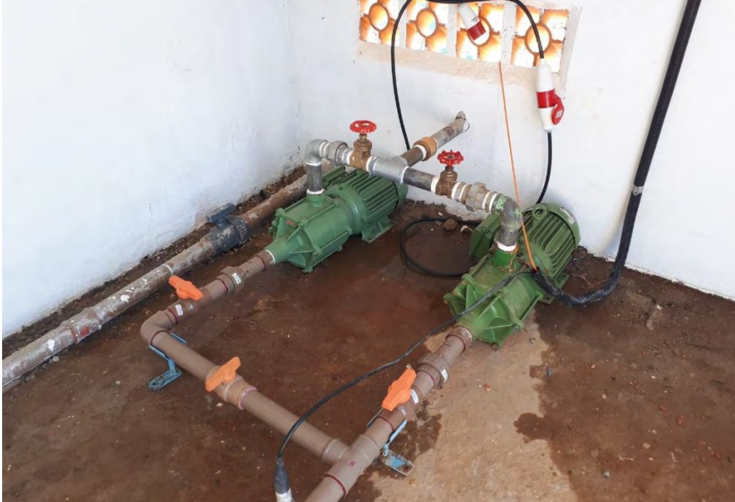
Figura 123: ERAT São Cristóvão - Conjuntos motobomba 7,5 cv - 10/2022.
