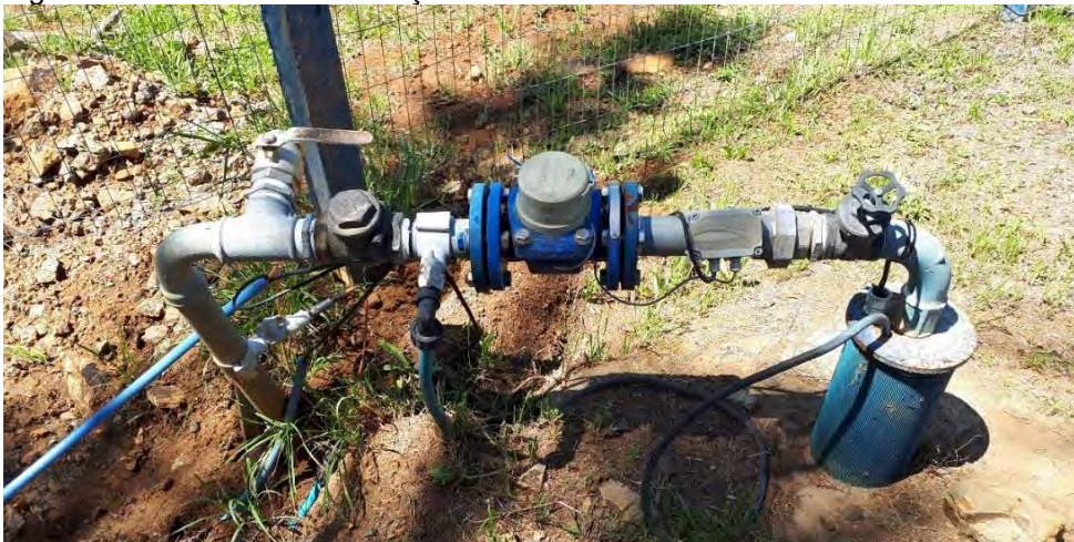
Figura 126: Cavalete P03 – Poço Macieira - 10/2022.
