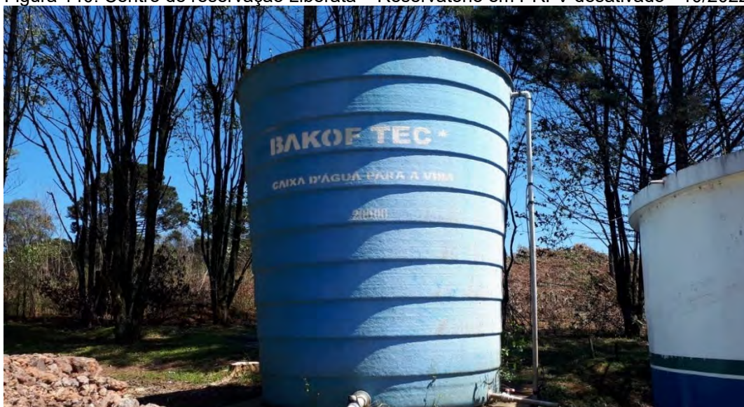
Figura 140: Centro de reservação Liberata – Reservatório em PRFV desativado - 10/2022.
