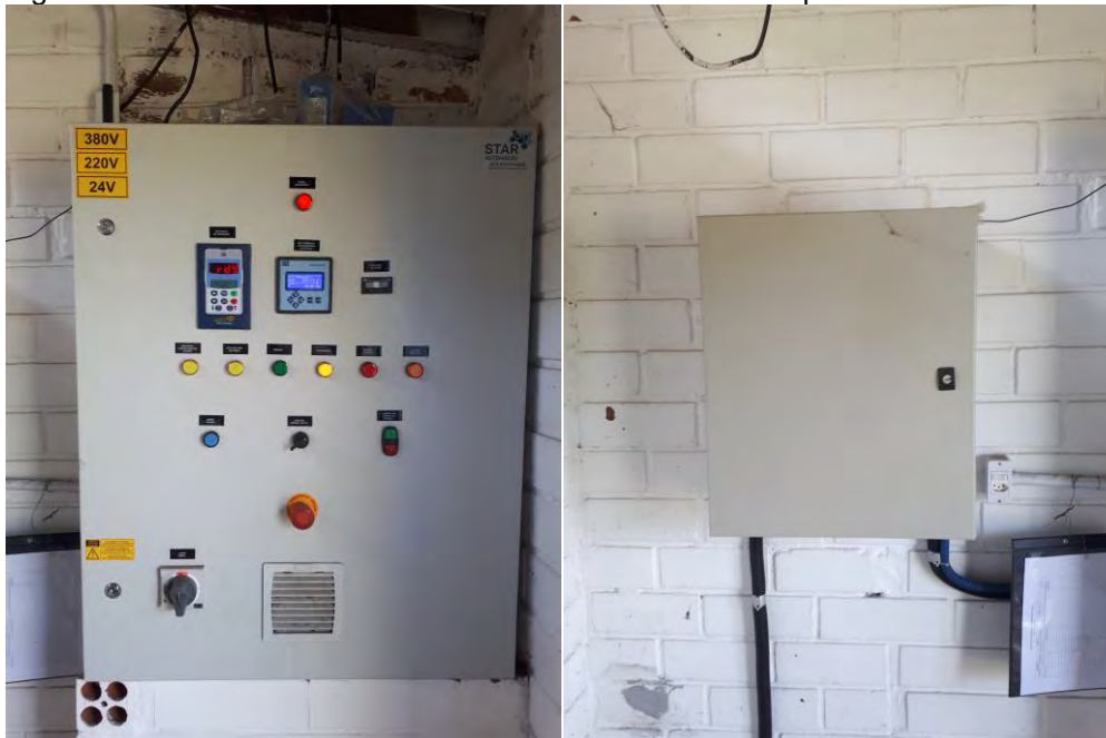
Figura 99: ERAT 01 – Painel de comando com soft starter e painel de telemetria -10/2022.
