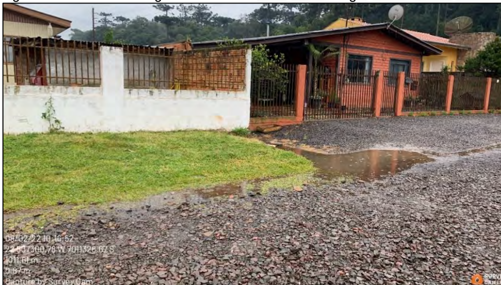
Figura 327: Acúmulo de água devido à falta de microdrenagem – 09/2022.
