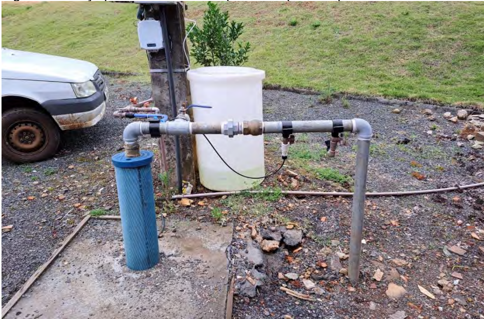
Figura 146: Poço profundo do SAA Papuã e tanque de hipoclorito de sódio ao fundo – 07/2024.
