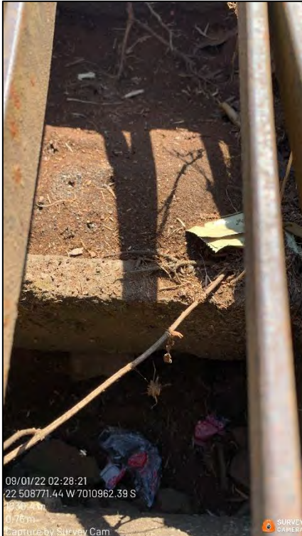
Figura 275: Interior de uma das bocas de lobo da AP-10 – 09/2022.
