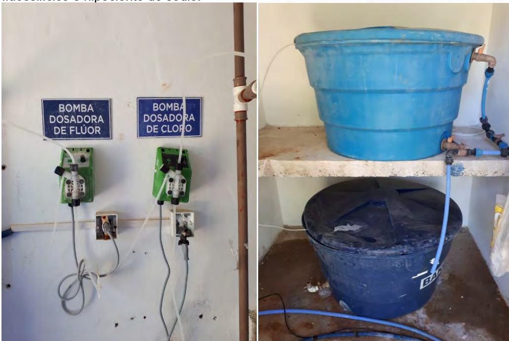
Figura 82: UTS P13 – Bombas dosadoras e tanques de armazenamento dos produtos químicos: ácido fluossilícico e hipoclorito de sódio.
