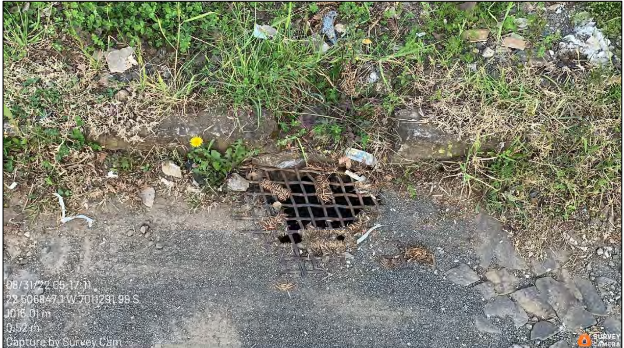
Figura 270: Boca de lobo na AP-9 – 08/2022.
