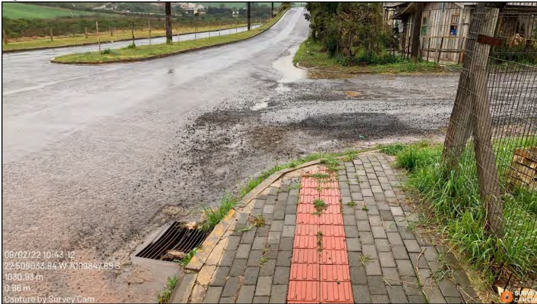
Figura 319: Acúmulo de água e sedimentos – 09/2022.
