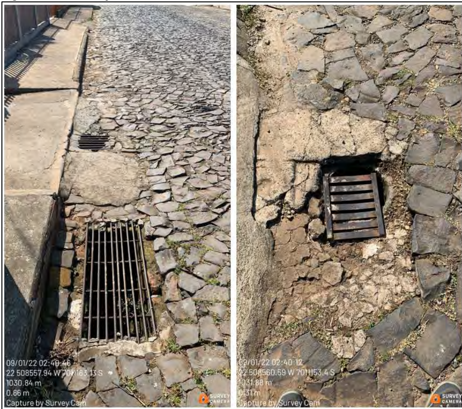
Figura 252: Condições das bocas de lobo da AP-05 verificadas em visita técnica – 09/2022.
