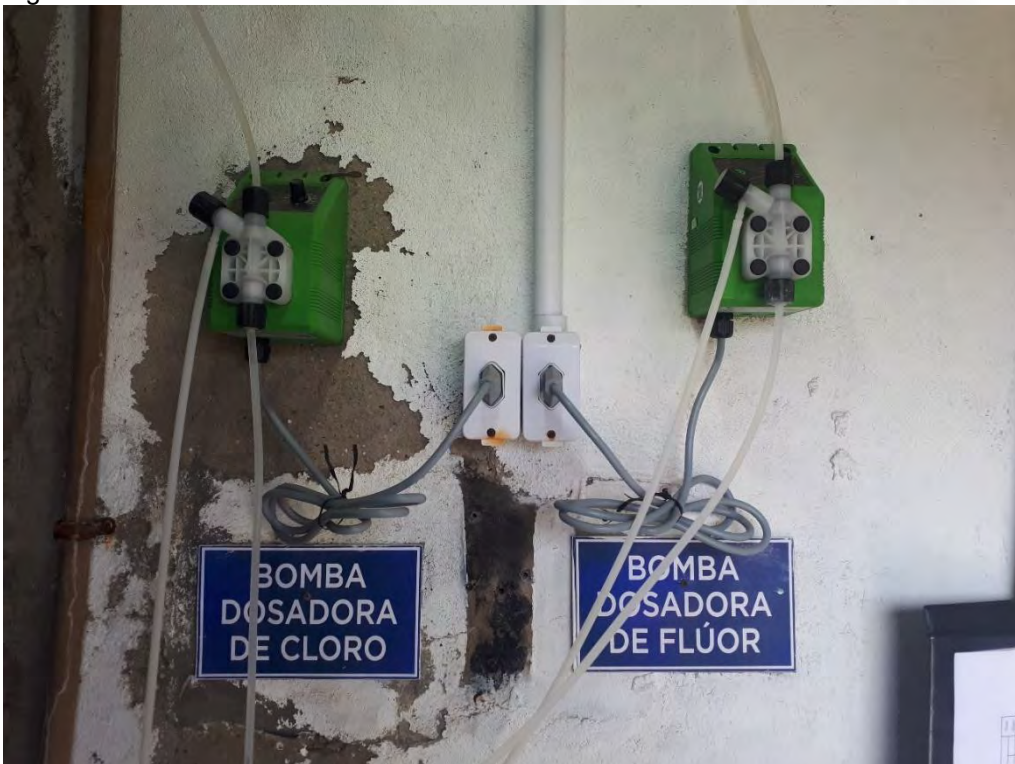
Figura 50: Sistema de tratamento do P01 – Bombas dosadoras -10/2022.
