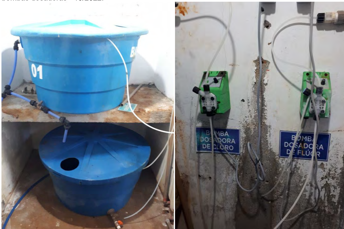
Figura 134: Sistema de tratamento do P06 – Tanques de armazenamento de produtos químicos e bombas dosadoras - 10/2022.
