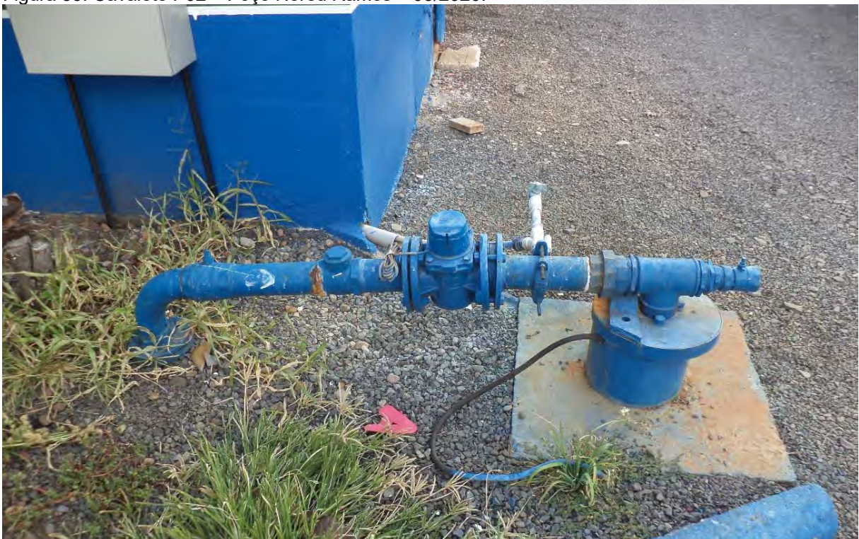
Figura 53: Cavalete P02 – Poço Nereu Ramos – 03/2020.
