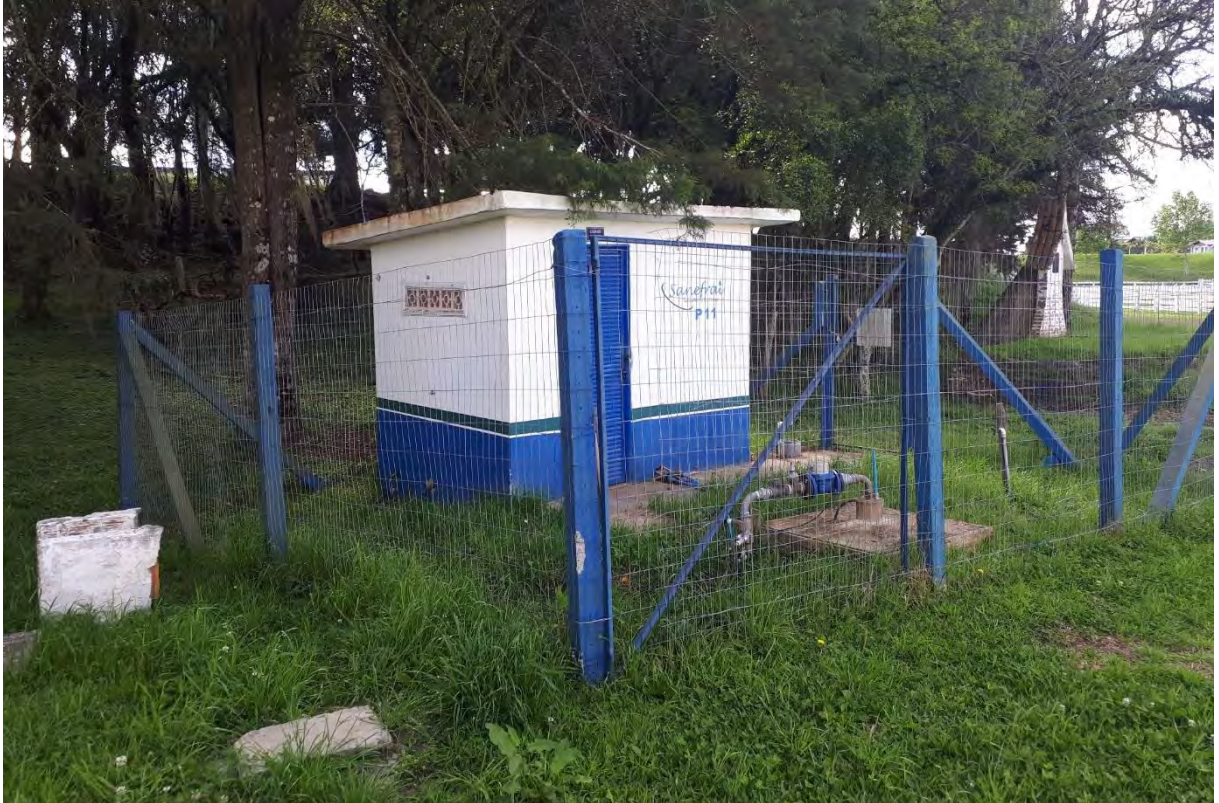
Figura 150: Visão geral da captação P11 – Poço Parque da Maçã – 10/2022.
