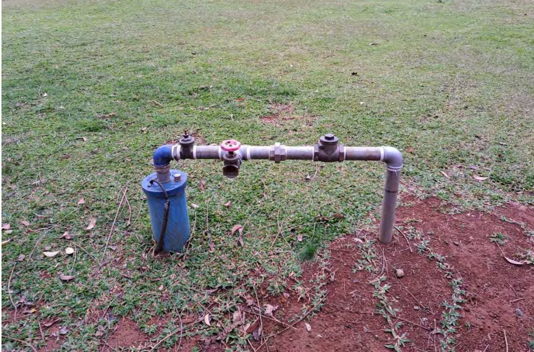
Figura 143: Poço profundo do SAA Papuã – 07/2024.
