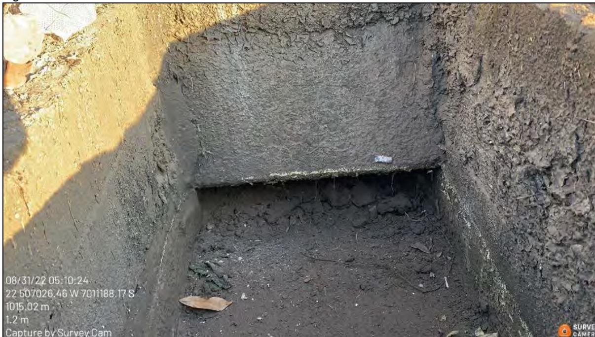
Figura 256: Interior de uma boca de lobo da AP-06 – 08/2022.
