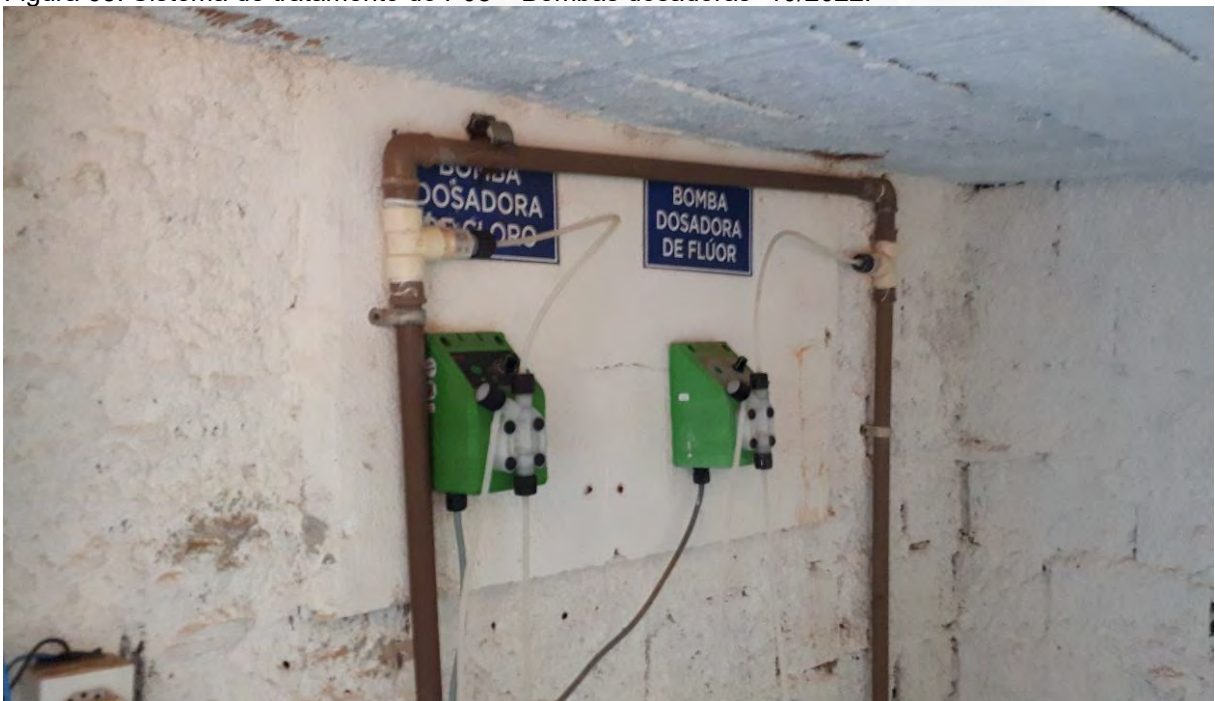
Figura 68: Sistema de tratamento do P08 – Bombas dosadoras -10/2022.
