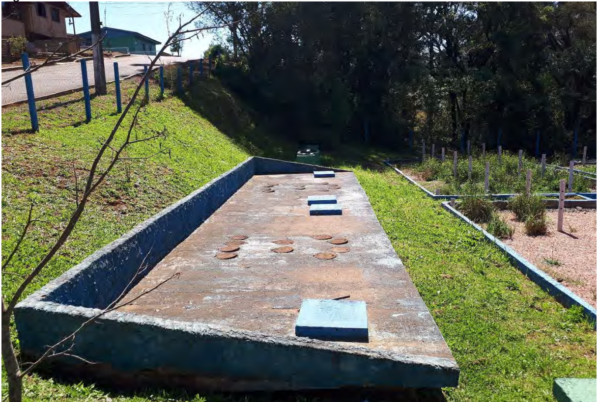
Figura 172: Reatores anaeróbios de leito fixo – 10/2022.
