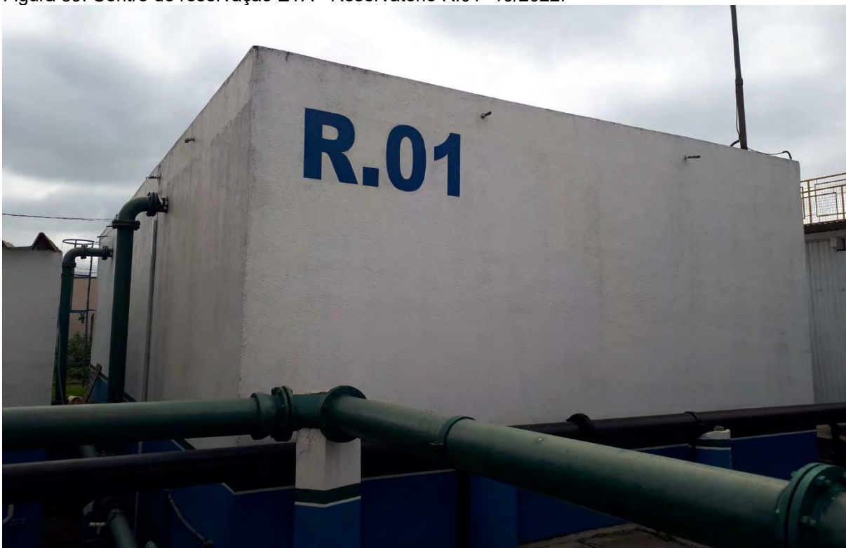
Figura 89: Centro de reservação ETA - Reservatório R.01 -10/2022.
