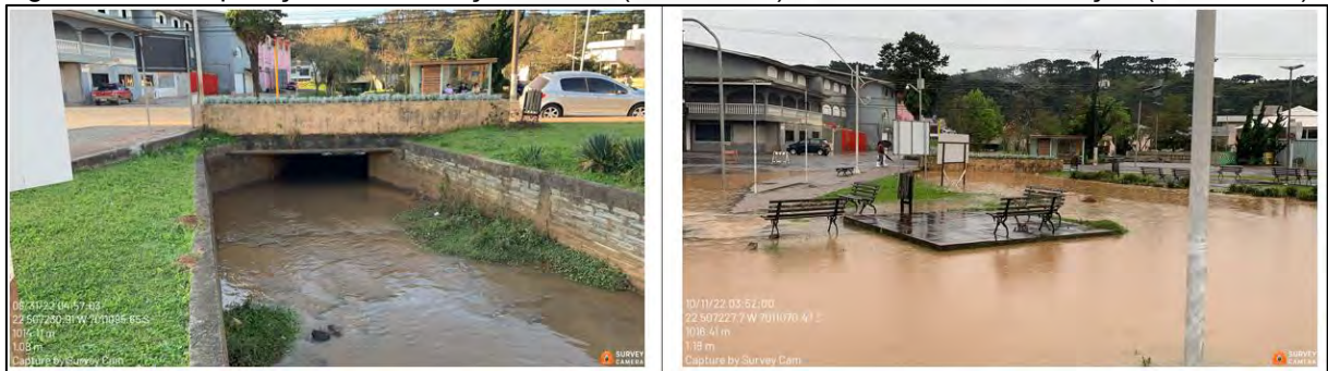
Figura 296: Comparação entre situação normal (31/08/2022) e em evento de inundação (11/10/2022).
