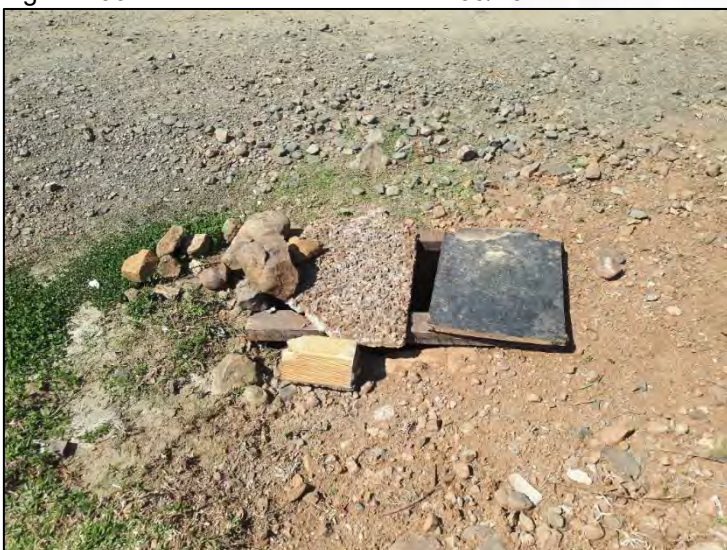
Figura 299: Boca de lobo danificada – 09/2022.
