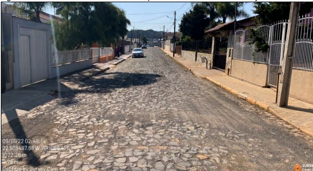
Figura 302: Acúmulo de sedimentos e rampas de acesso aos lotes na sarjeta – 09/2022.
