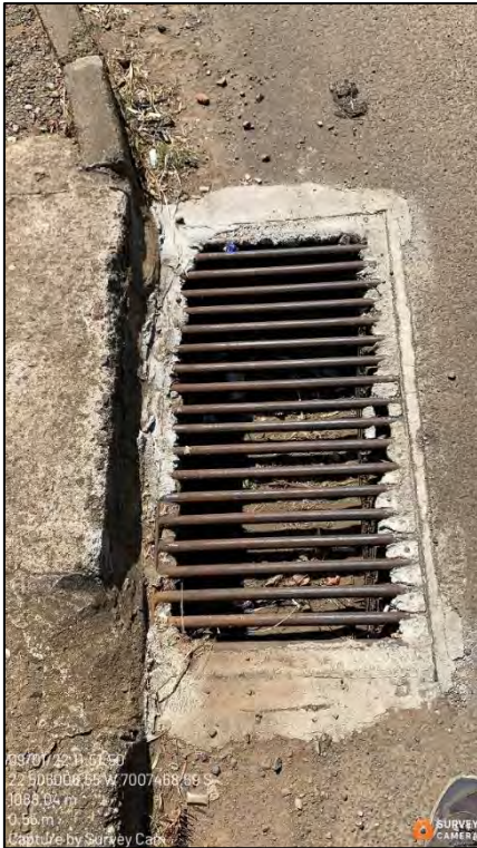
Figura 300: Boca de lobo com acúmulo de sedimentos – 09/2022.
