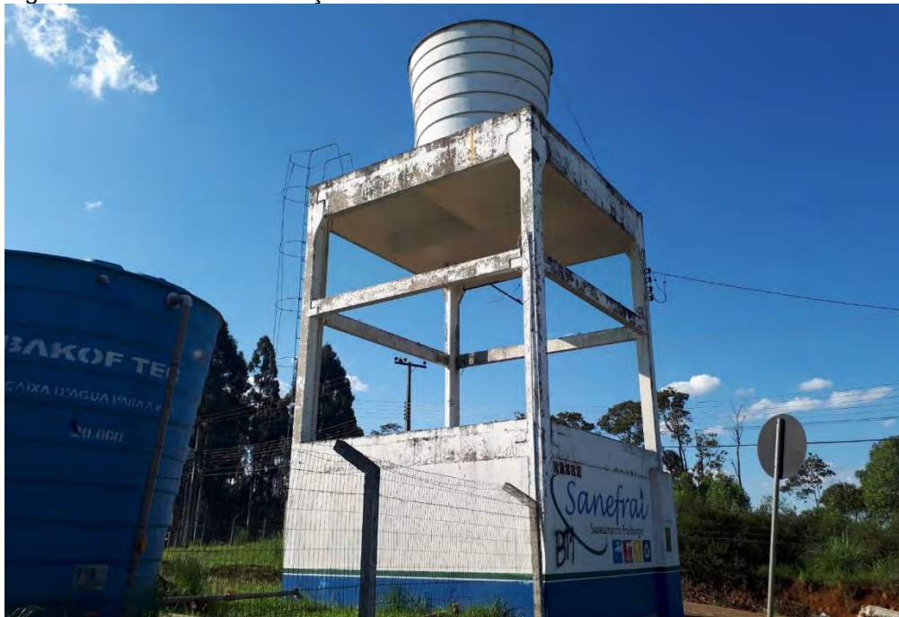
Figura 94: Centro de reservação Mirassol – Reservatório de 20 m³ em PRFV elevado - 10/2022.
