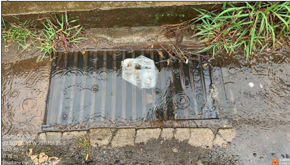
Figura 325: Boca de lobo obstruída – 09/2022.
