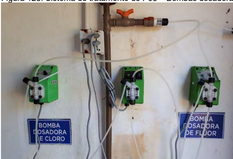
Figura 128: Sistema de tratamento do P03 – Bombas dosadoras - 10/2022.
