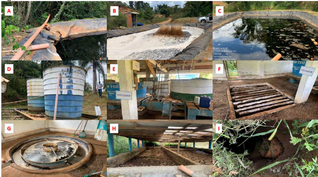
Figura 192: Sistema de tratamento de chorume – em 01/2022.
