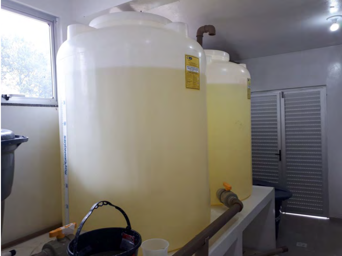
Figura 43: Casa de química – Produtos químicos – Hipoclorito de Sódio -10/2022.
