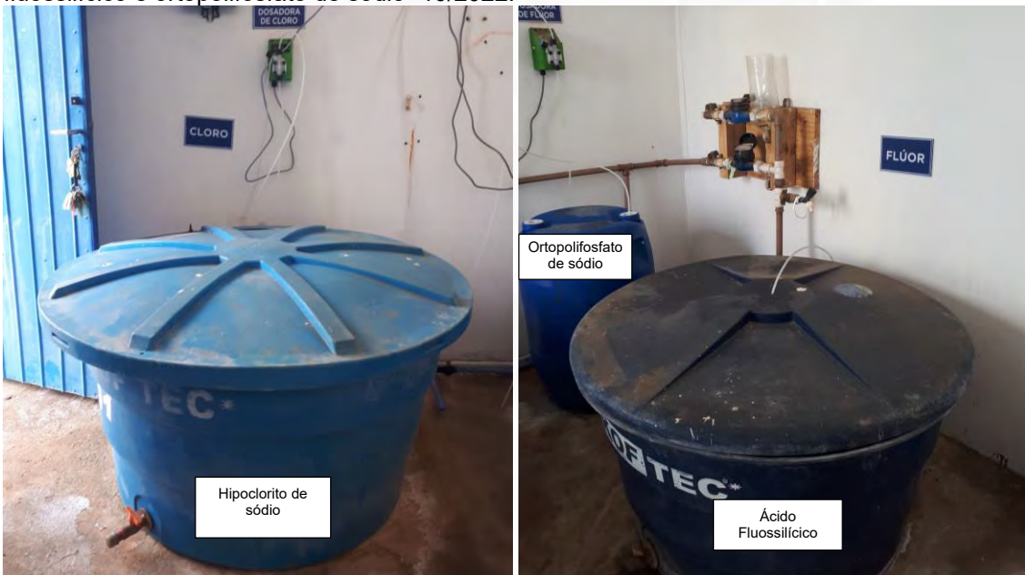
Figura 79: UTS P12 – Tanques de armazenamento dos produtos químicos: hipoclorito de sódio, ácido fluossilícico e ortopolifosfato de sódio -10/2022.
