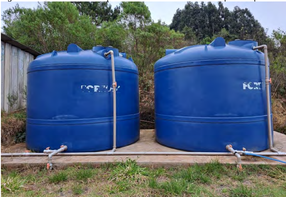
Figura 147: Centro de reservação do SAA X de novembro – tanques em polietileno - 40 m 3 - 07/2024.
