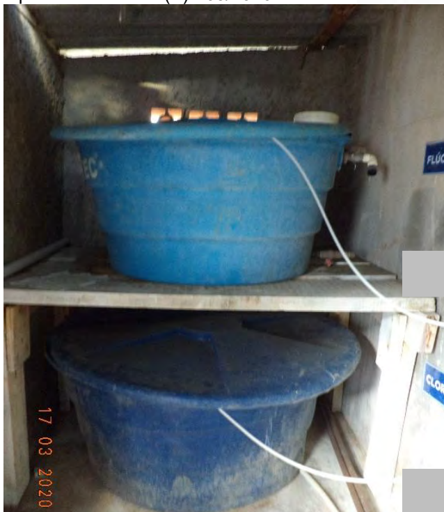
Figura 55: UTS P02 – Tanques de armazenamento dos produtos químicos: ácido fluossilícico (A) e hipoclorito de sódio(B) - 03/2020.
