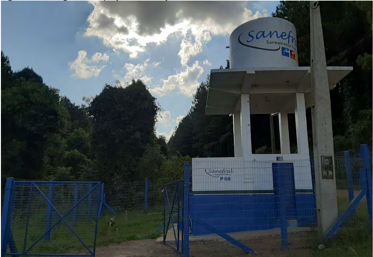
Figura 67: Visão geral da captação P08 – Poço Vila Nova -10/2022.
