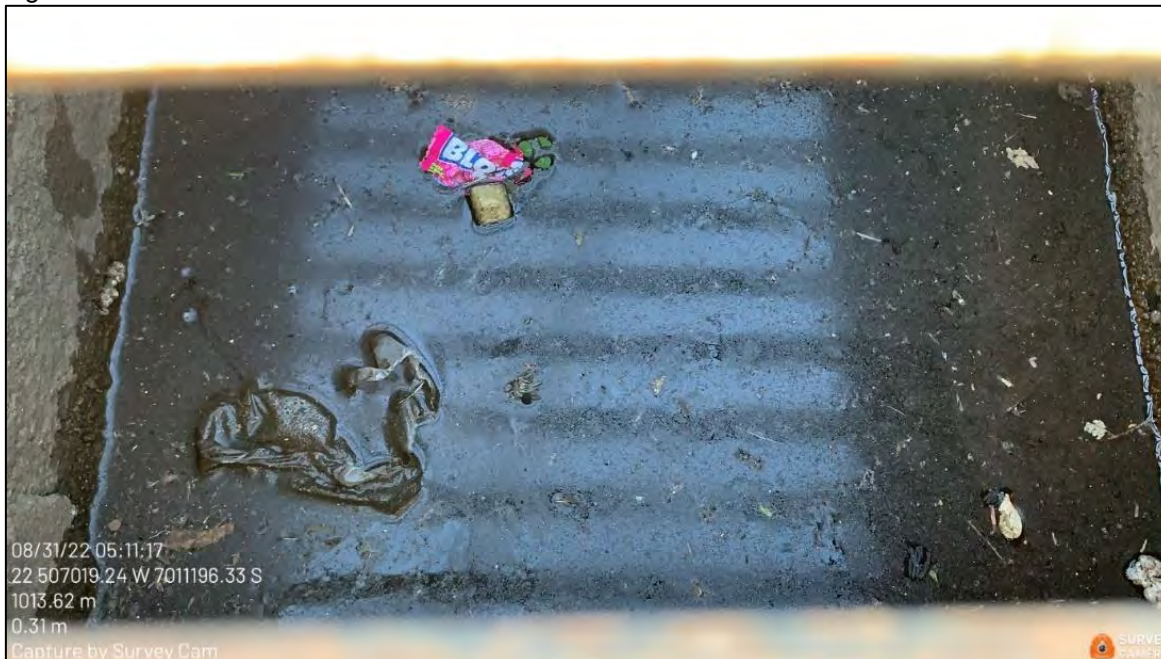
Figura 257: Interior de uma boca de lobo da AP-06 – 08/2022.
