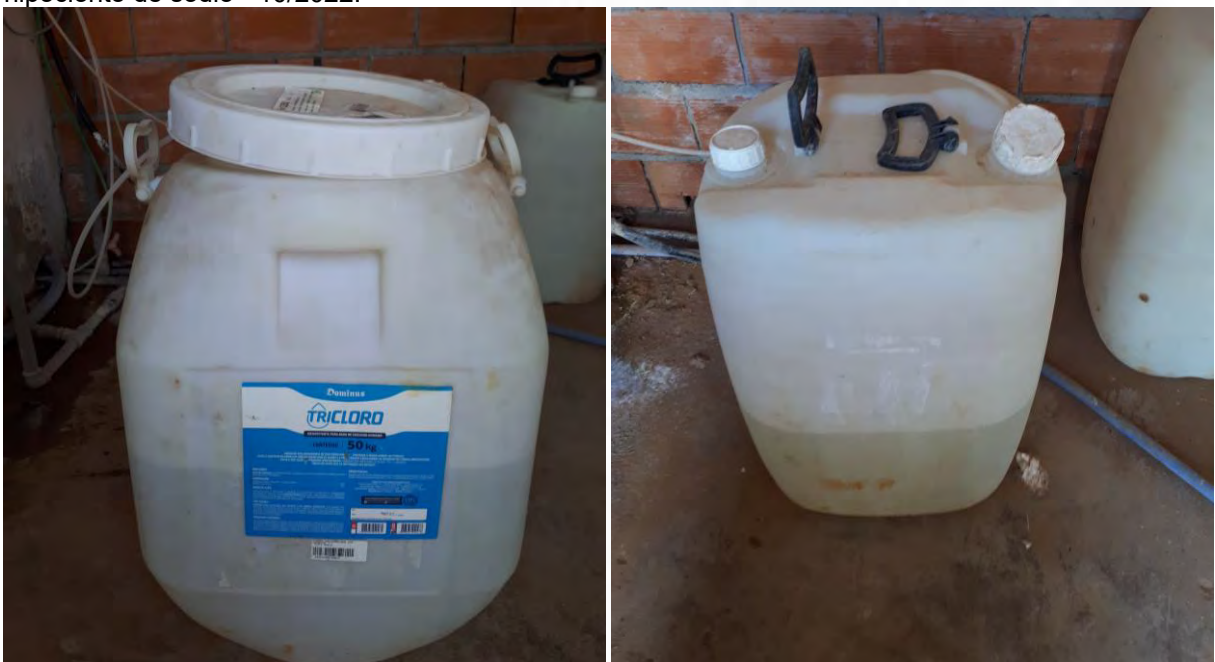
Figura 74: Poço P09– Bombonas de armazenamento dos produtos químicos: ácido fluossilícico e hipoclorito de sódio -10/2022.
