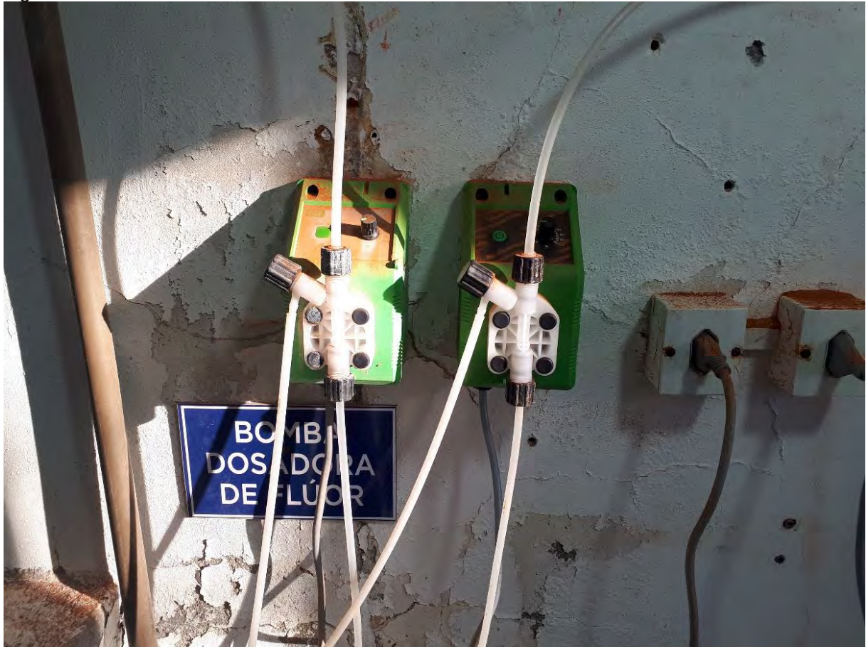
Figura 59: Sistema de tratamento do P04 – Bombas dosadoras -10/2022.
