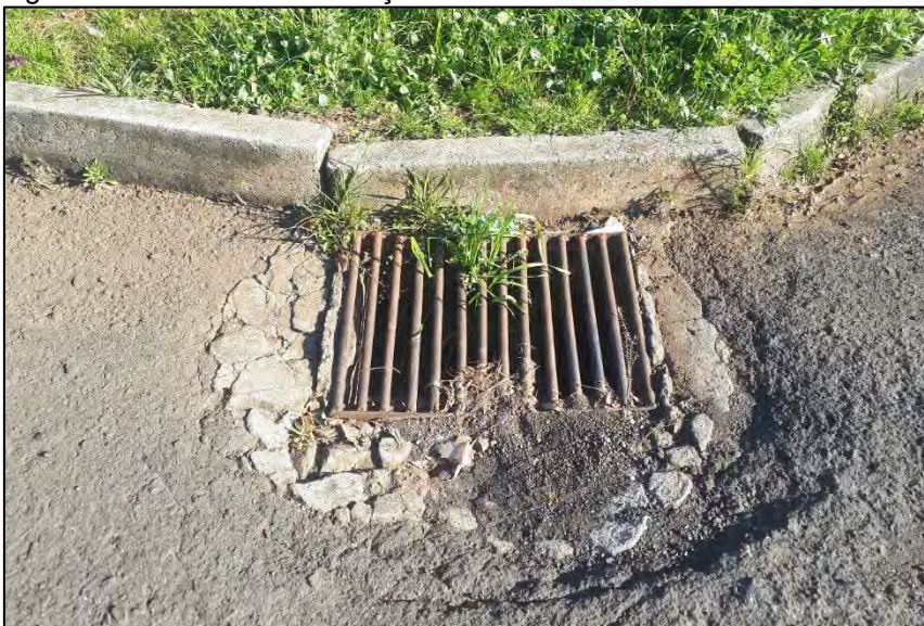
Figura 288: Falta de manutenção verificada na boca de lobo – 08/2022.
