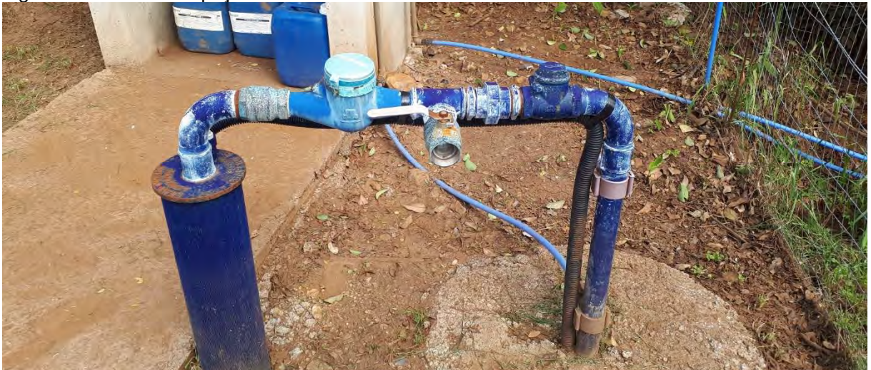
Figura 88: Cavalete do poço P18 - 10/2022.
