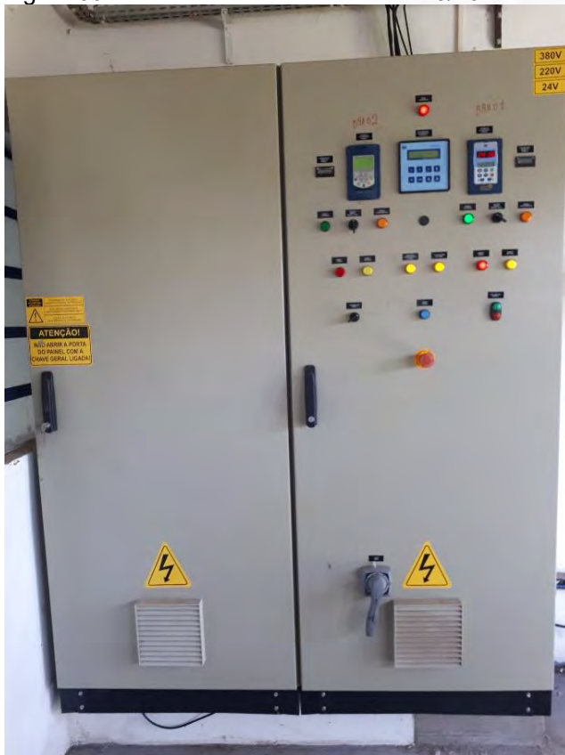
Figura 33: Paineis de comando - ERAB -10/2022.
