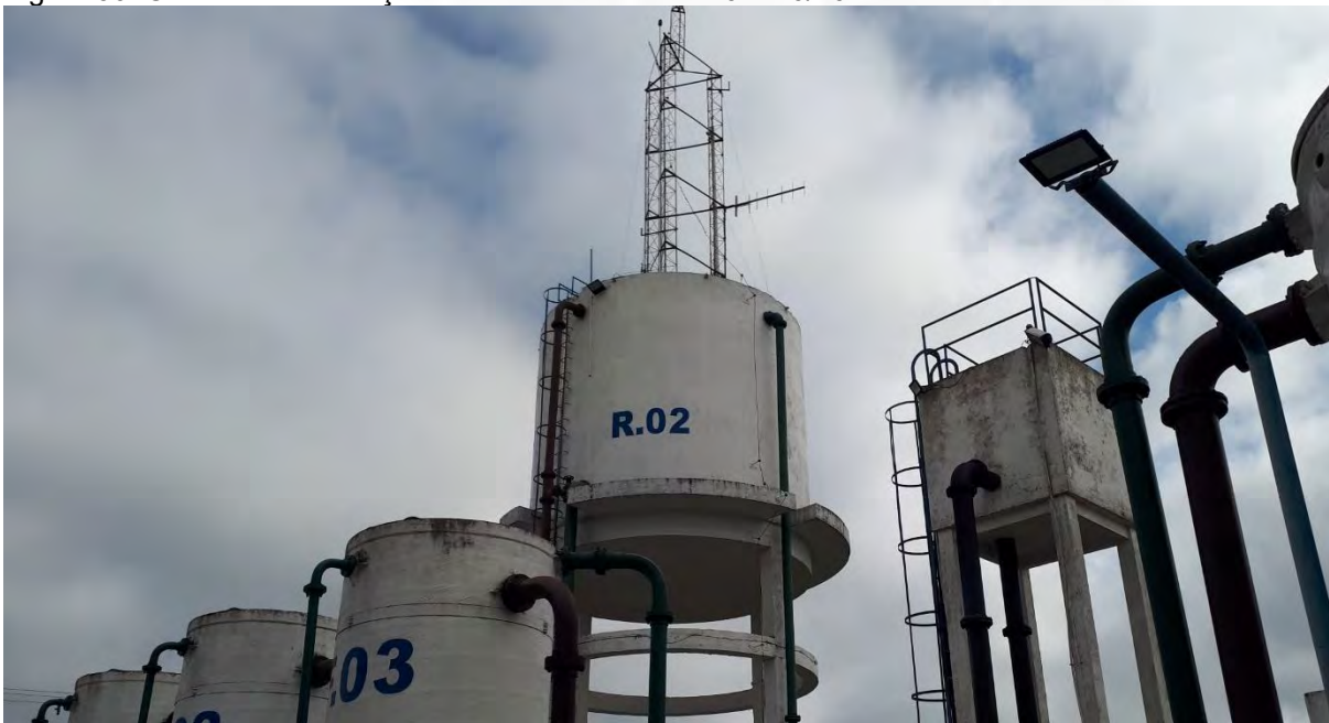
Figura 90: Centro de reservação ETA - Reservatório R.02 -10/2022.
