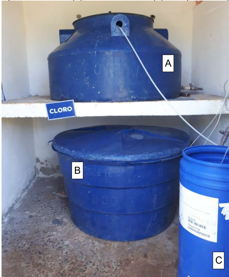
Figura 129: Sistema de tratamento do P03 – Tanques de armazenamento dos produtos químicos: hipoclorito de sódio(A), ácido fluossilícico (B) e ortopolifosfato (C) - 10/2022.
