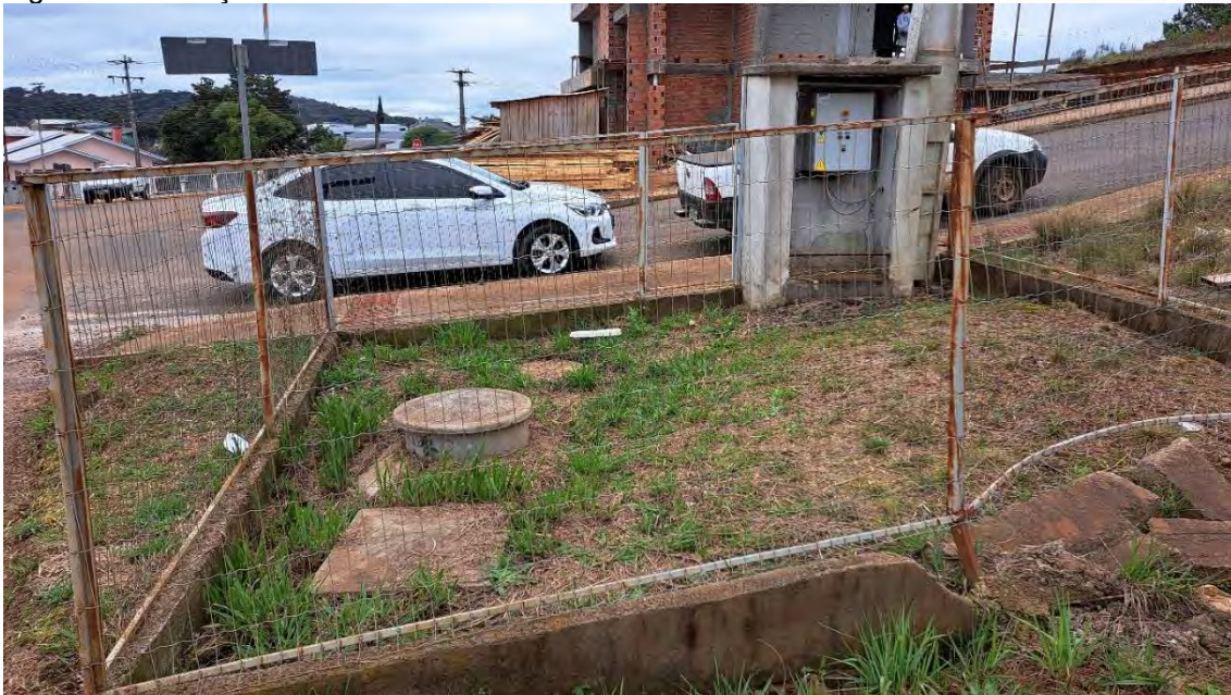
Figura 182: Estação elevatória - SES Solar das Hortênsias – em 07/2024.
