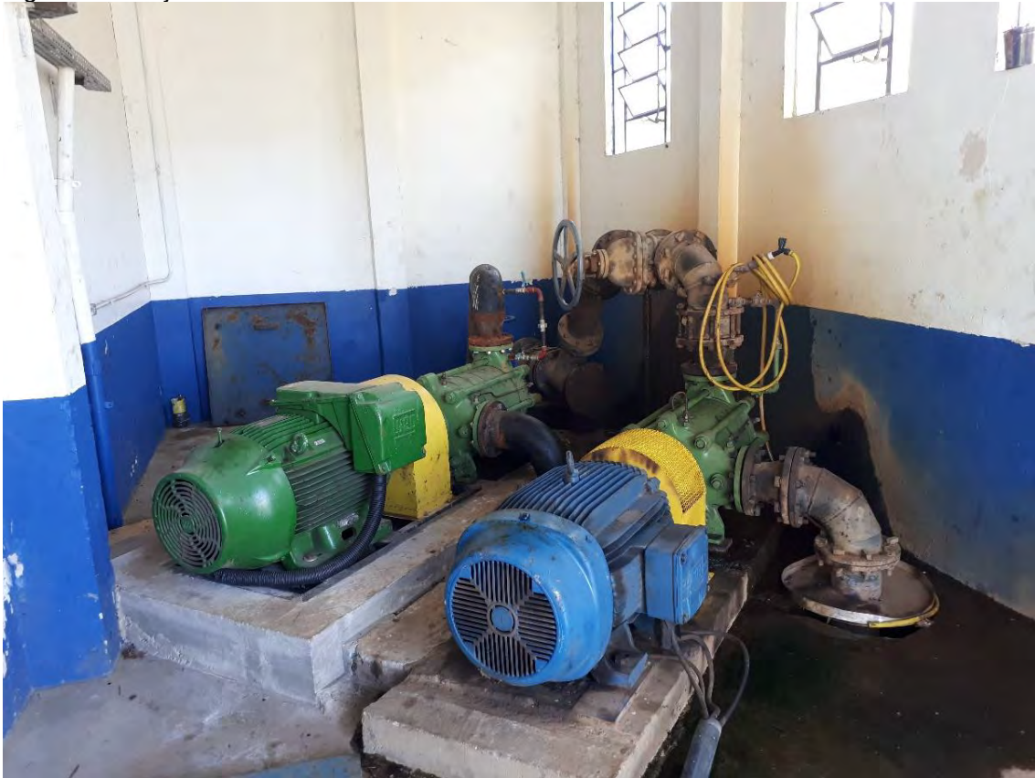
Figura 32: Conjuntos motobomba ERAB -10/2022.
