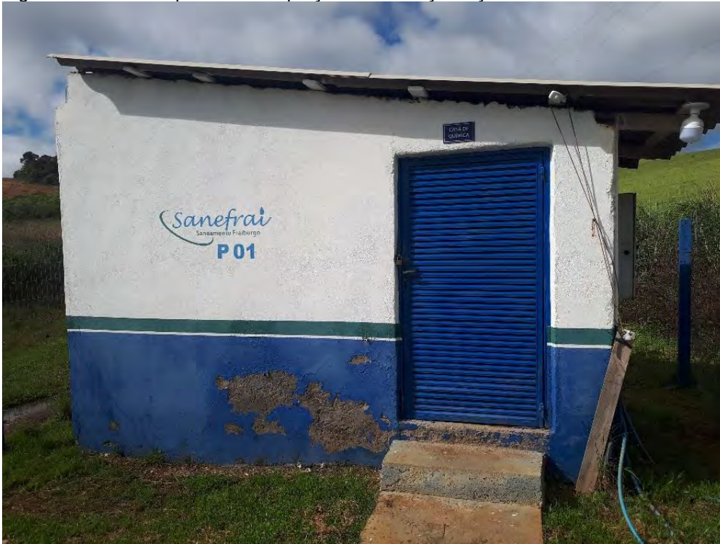
Figura 49: Casa de química da captação P01 – Poço Nações -10/2022.
