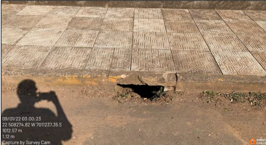
Figura 243: Boca de Lobo - AP2 – 09/2022.
