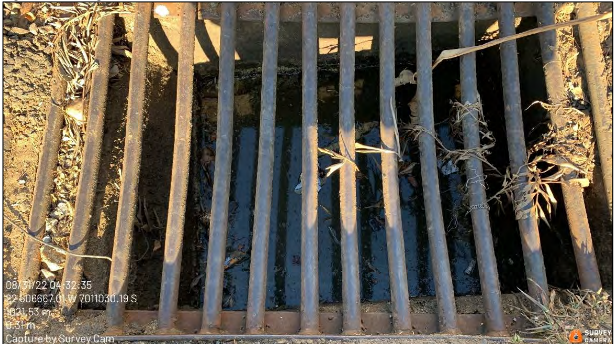
Figura 238: Imagem de boca de lobo da AP-01 – 08/2022.
