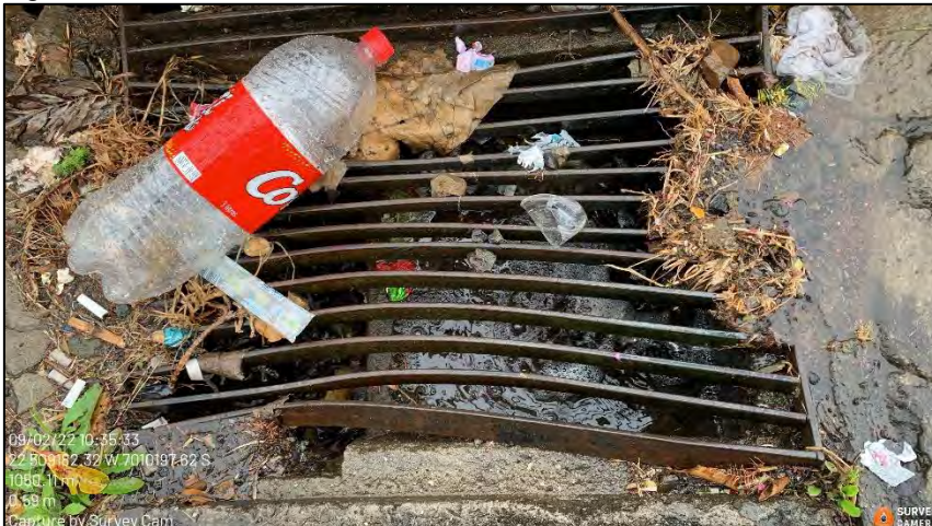
Figura 314: Bocas de lobo com acúmulo de resíduos – 09/2022.
