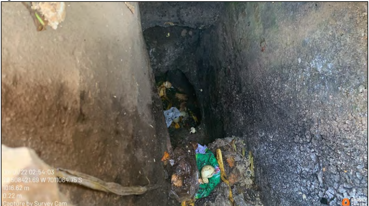
Figura 266: Resíduos sólidos no interior da boca de lobo – 09/2022.
