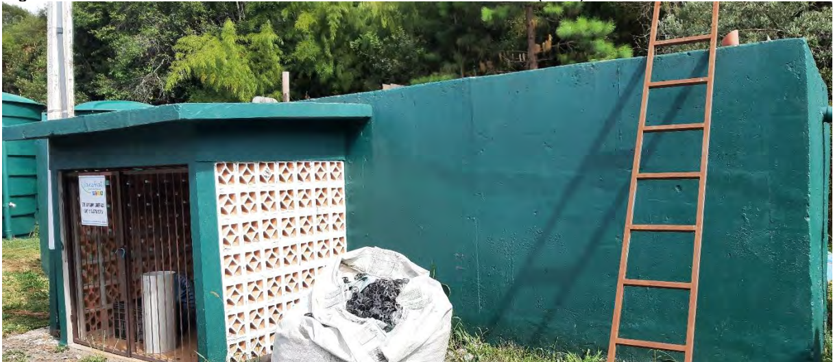
Figura 167: Tratamento secundário – Biofiltros Aerado Submerso (BAS) – 01/2022.
