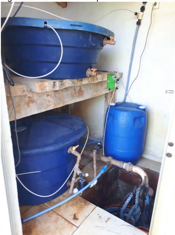
Figura 137: Cavalete e tanque de armazenamento de produtos químicos do poço P15 - 10/2022.
