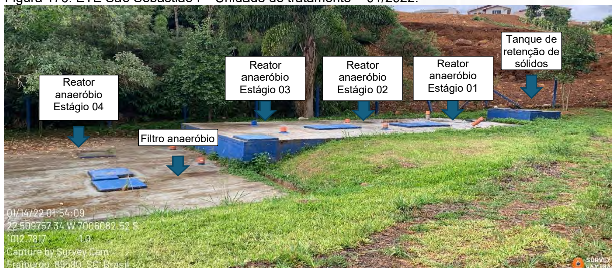
Figura 176: ETE São Sebastião I – Unidade de tratamento – 01/2022.
