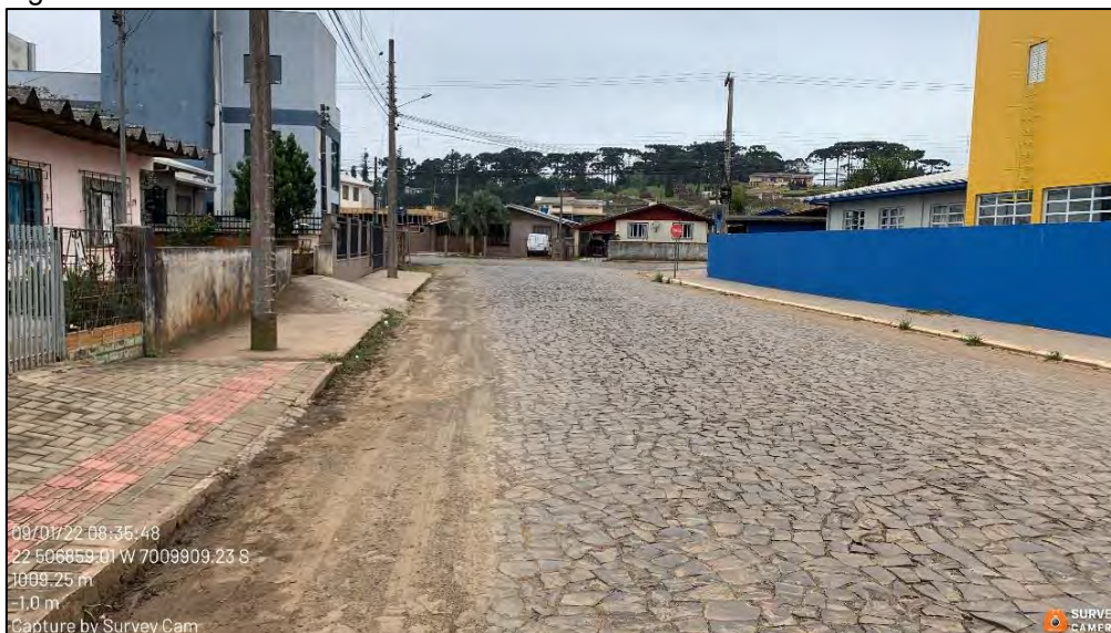
Figura 248: Acúmulo de sedimentos na AP-4 – 09/2022.
