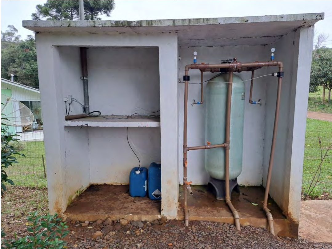
Figura 144: Estrutura de tratamento do SAA Papuã – 07/2024.
