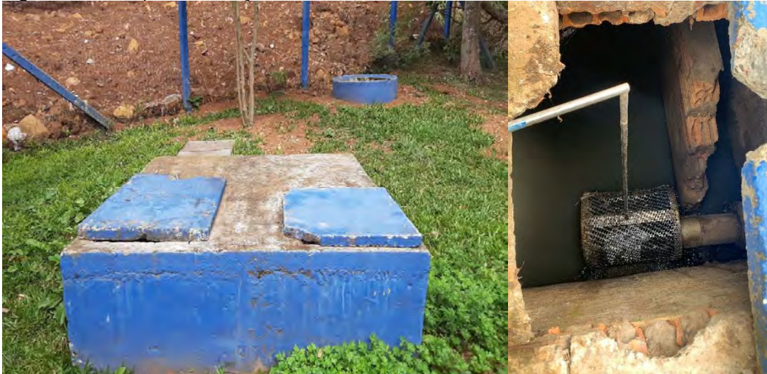
Figura 175: Tanque de retenção de sólidos sedimentáveis e cesto metálico – 01/2022.
