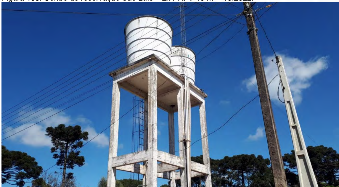
Figura 138: Centro de reservação São Luís – 2x PRFV 10 m 3 - 10/2022.
