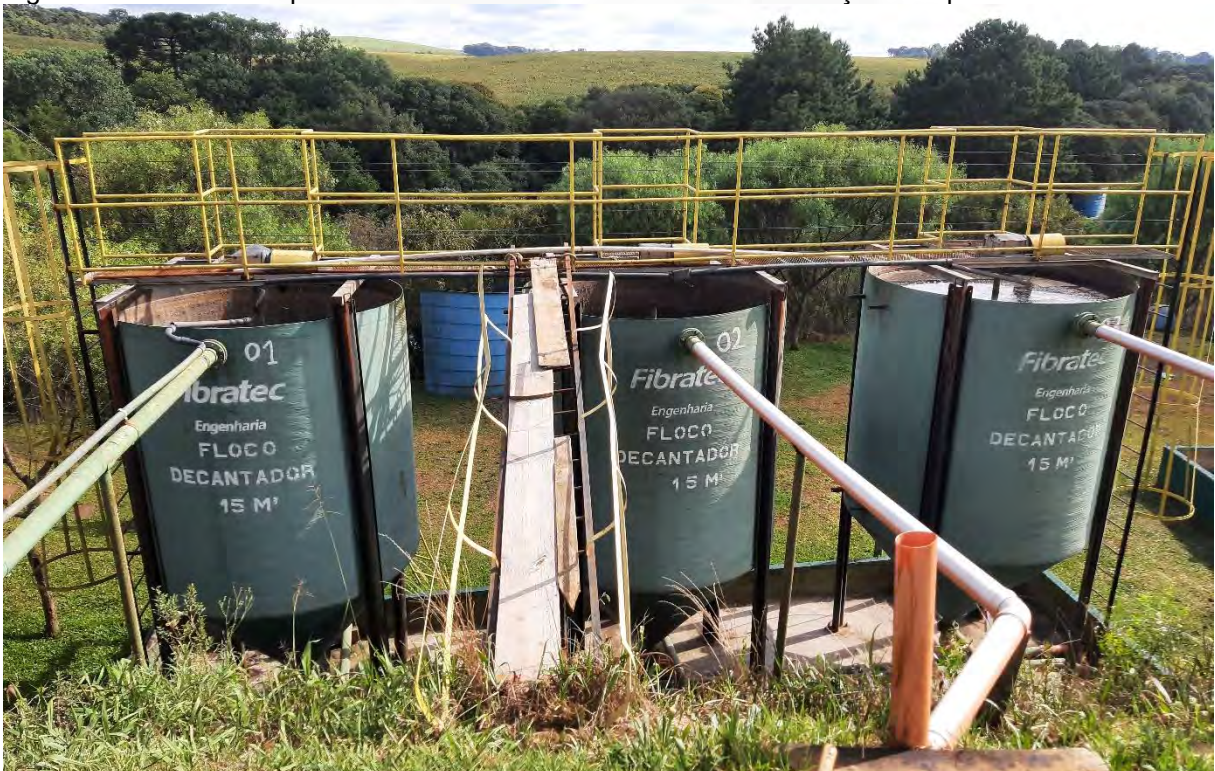
Figura 162: Tratamento primário – Floccodecantador – efluente do serviço de limpa fossa – 01/2022.
