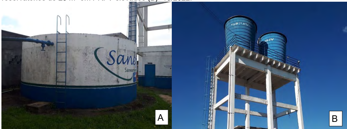
Figura 93: Centro de reservação São Sebastião – Reservatório de 150 m 3 em concreto apoiado (A) e 2 reservatórios de 25 m 3 em PRFV elevados (B) -10/2022.
