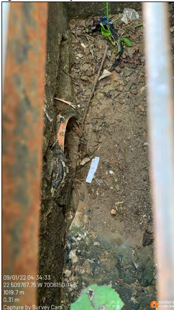
Figura 283: Tubulação de saída da boca de lobo – 09/2022.
