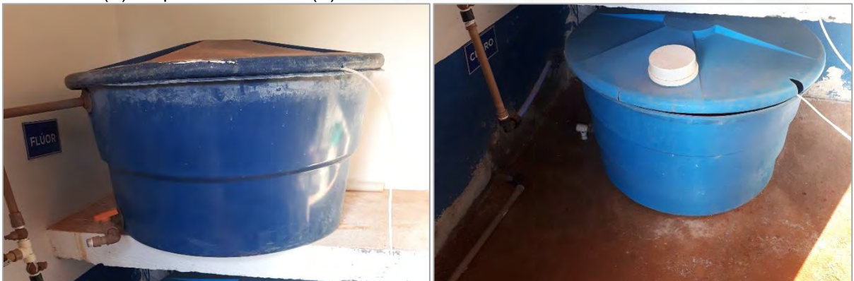
Figura 60: Sistema de tratamento do P04 – Tanques de armazenamento dos produtos químicos: ácido fluossilícico (A) e hipoclorito de sódio(B) -10/2022.
