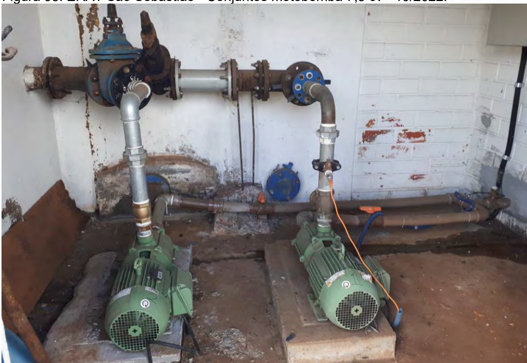
Figura 98: ERAT São Sebastião - Conjuntos motobomba 7,5 cv - 10/2022.
