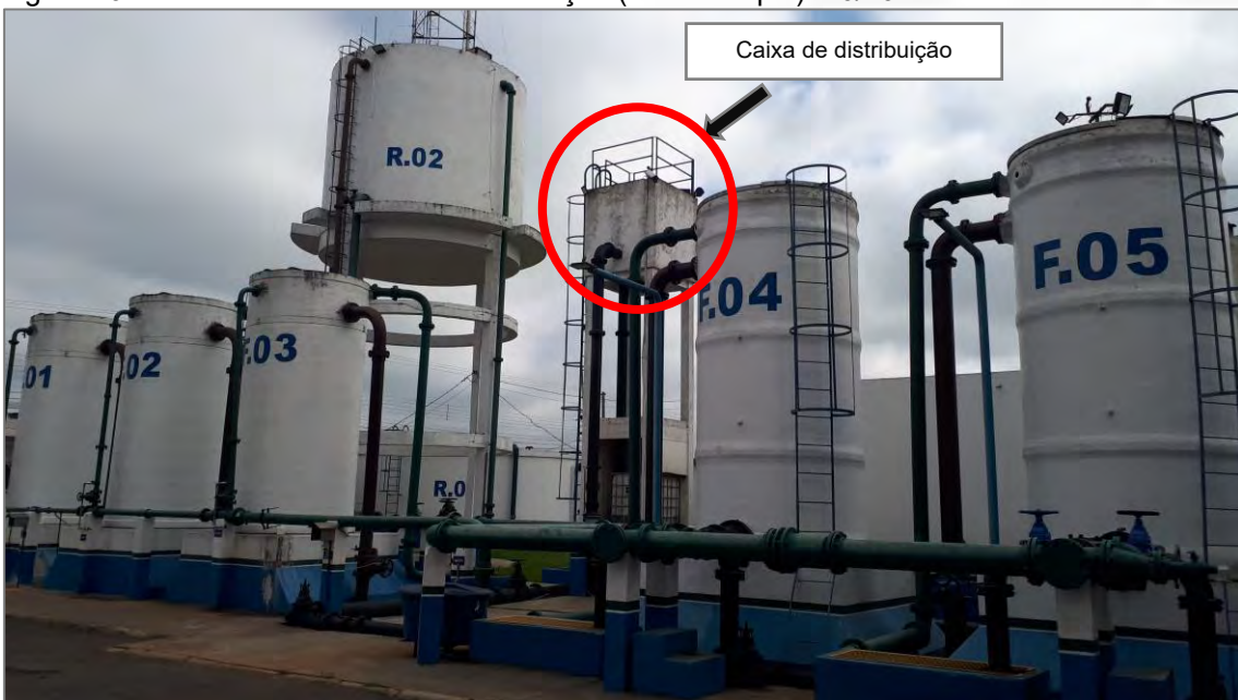
Figura 40: Filtros russos e caixa de distribuição (em destaque) -10/2022.
