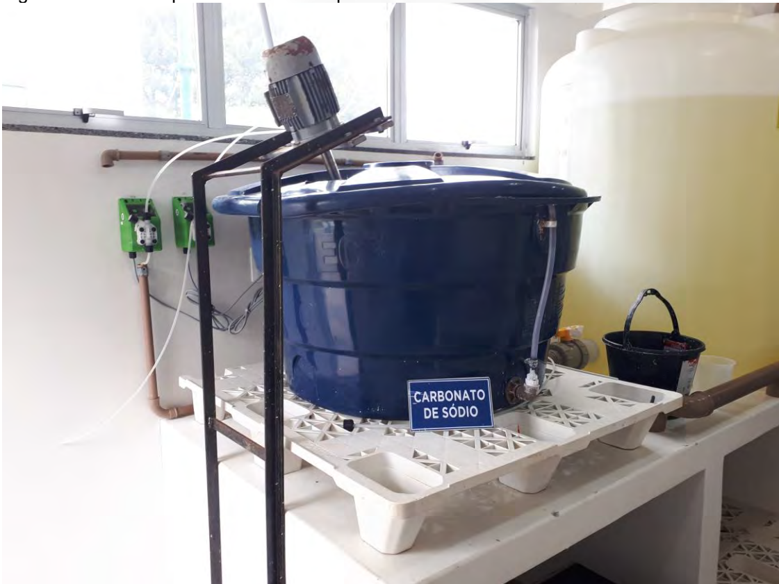
Figura 44: Casa de química – Produtos químicos – Carbonato de Sódio -10/2022.
