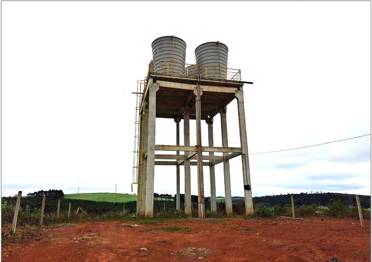
Figura 96: Centro de reservação Portal - 4x26 m³ em PRFV – 07/2024.
