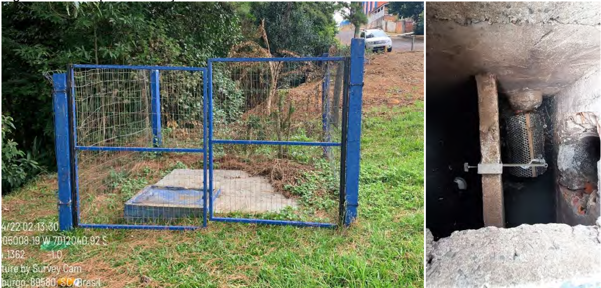
Figura 177: Tanque de retenção de sólidos sedimentáveis e cesto metálico – 01/2022.
