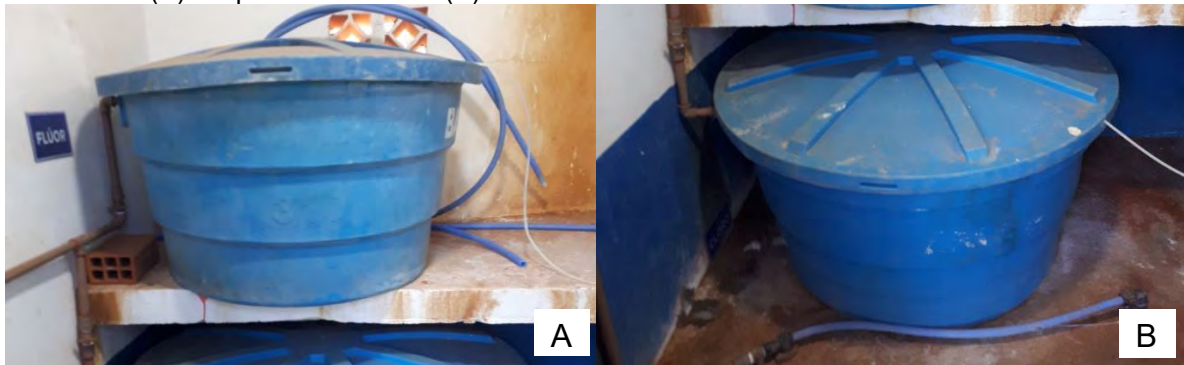
Figura 64: Sistema de tratamento do P05– Tanques de armazenamento dos produtos químicos: ácido fluossilícico (A) e hipoclorito de sódio(B) -10/2022.
