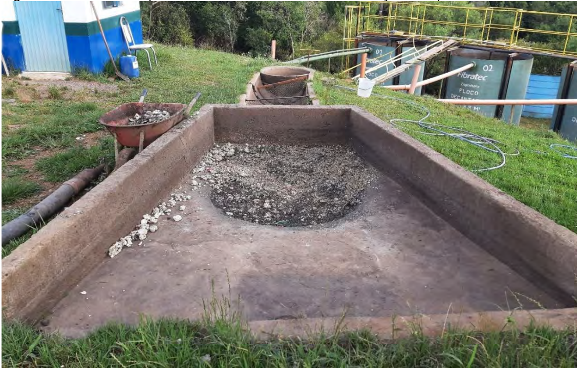
Figura 161: Tratamento preliminar – Entrada efluentes do serviço de limpa fossa – 01/2022.
