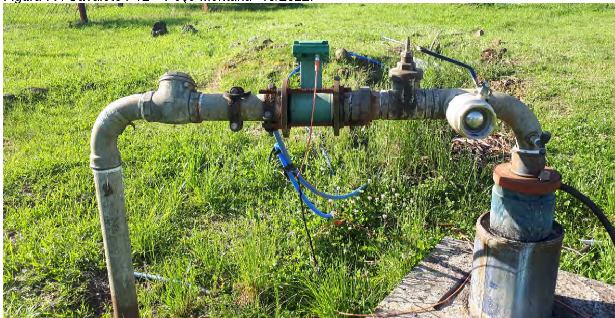
Figura 77: Cavalete P12 – Poço Montana -10/2022.
