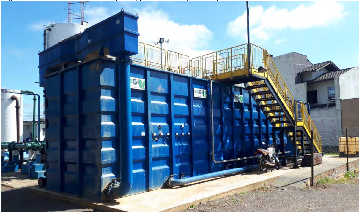
Figura 35: Floccodecantador compacto, pré-fabricado, com capacidade nominal de 25 l/s -10/2022.
