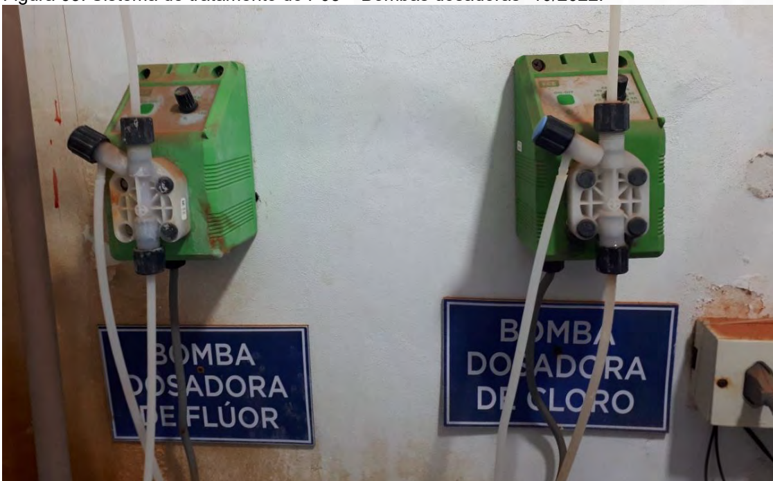
Figura 63: Sistema de tratamento do P05 – Bombas dosadoras -10/2022.
