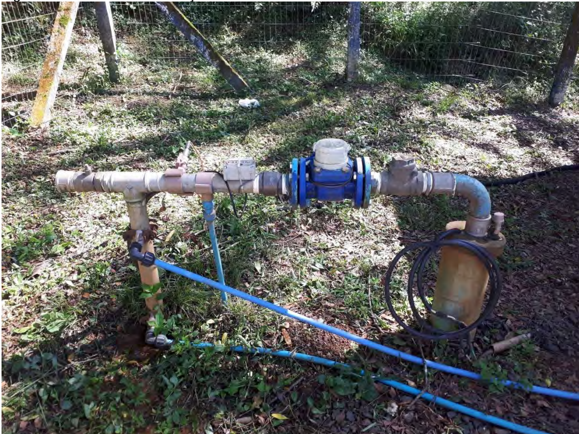
Figura 133: Cavalete P06 – Poço São Luís - 10/2022.
