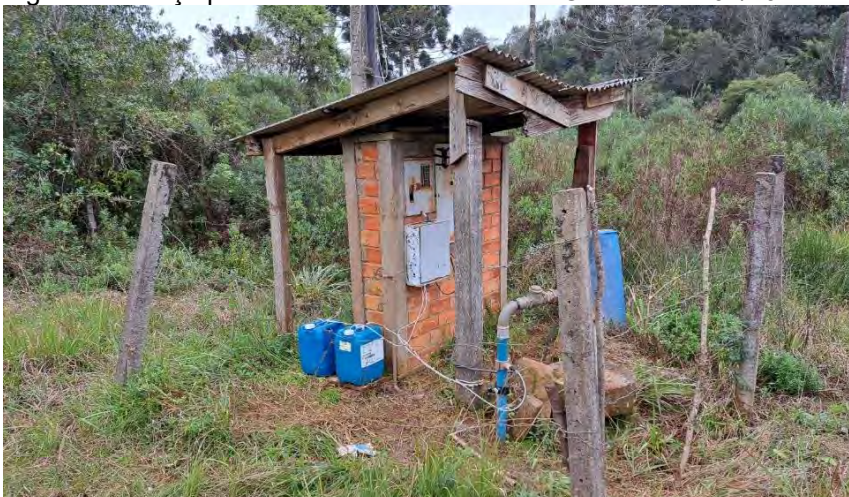
Figura 141: Poço profundo do SAA Faxinal dos Carvalhos – 07/2024.
