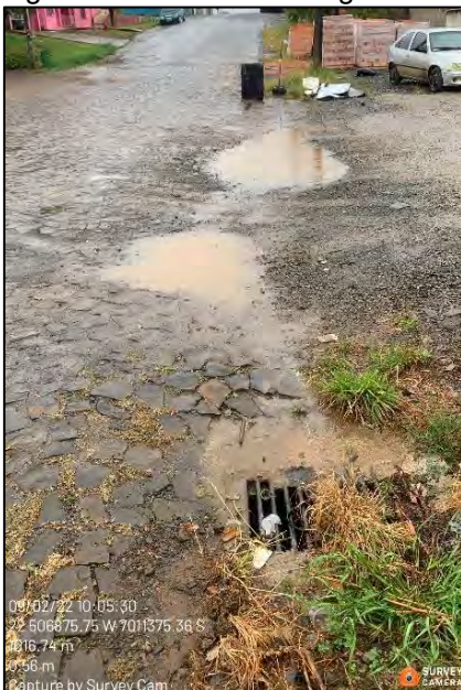
Figura 324: Acúmulo de água na via – 09/2022.
