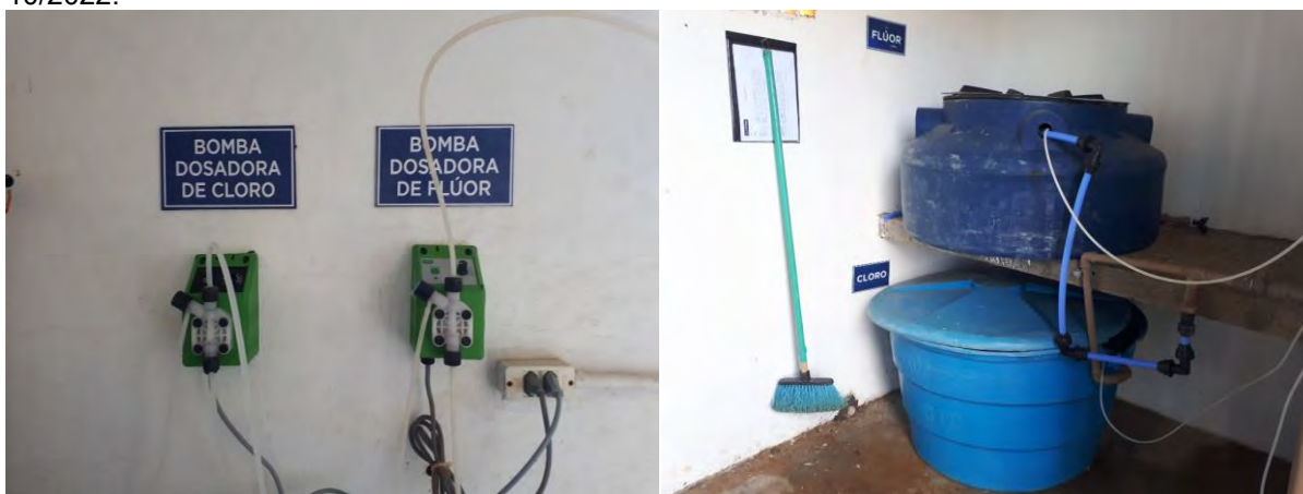
Figura 152: UTS P11 – Bombas dosadoras e tanques de armazenamento dos produtos químicos – 10/2022.
