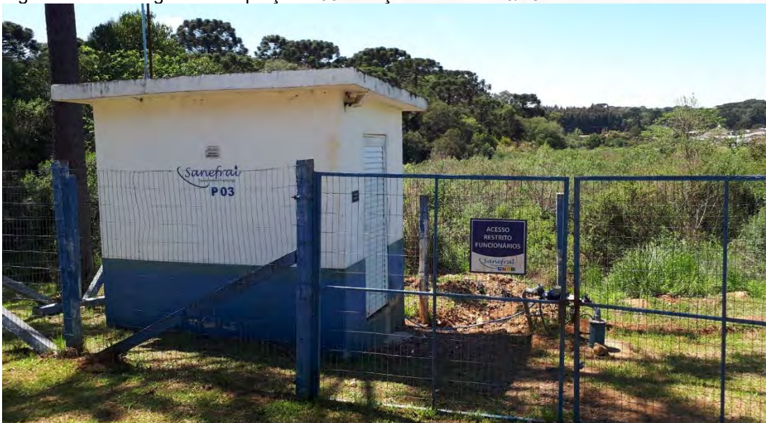
Figura 127: Visão geral da captação P03 – Poço Macieira - 10/2022.
