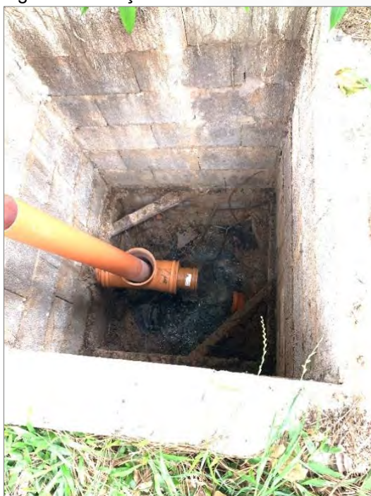
Figura 179: Poço de visita - saída do tratamento – 01/2022.
