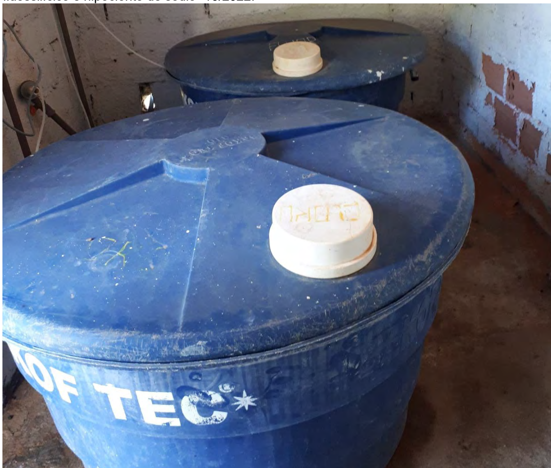
Figura 69: Sistema de tratamento do P08 – Tanques de armazenamento dos produtos químicos: ácido fluossilícico e hipoclorito de sódio -10/2022.
