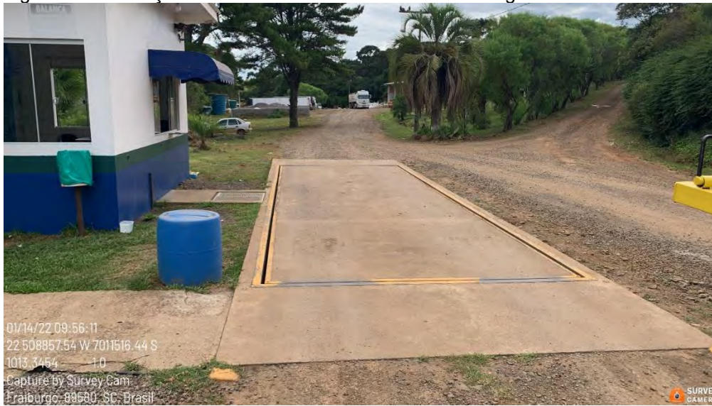
Figura 188: Balança rodoviária na entrada da central de triagem de resíduos – em 01/2022.
