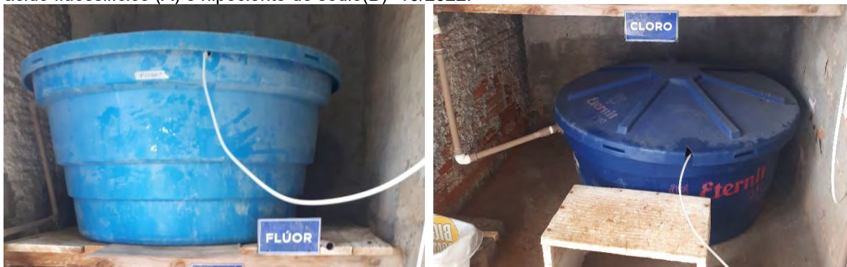
Figura 51: Sistema de tratamento do P01 – Tanques de armazenamento dos produtos químicos: ácido fluossilícico (A) e hipoclorito de sódio(B) -10/2022.
