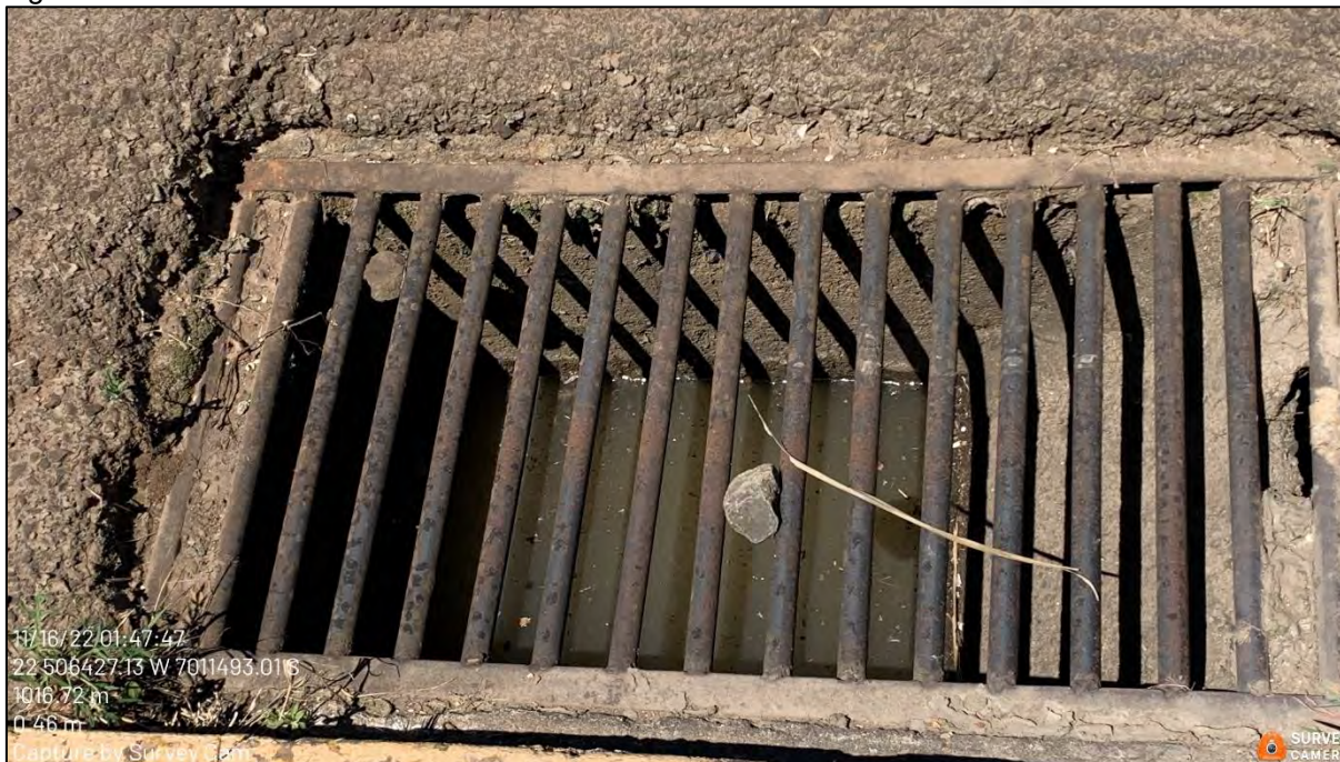
Figura 262: Boca de lobo obstruída na AP-07 – 11/2022.
