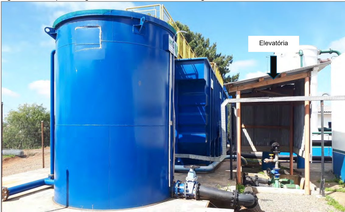
Figura 39: Tanque de água decantada e elevatória de água -10/2022.
