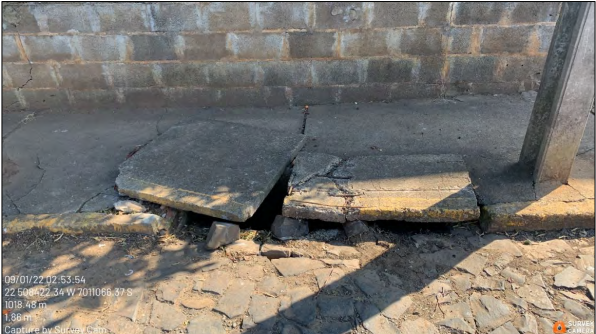
Figura 265: Boca de lobo danificada – 09/2022.
