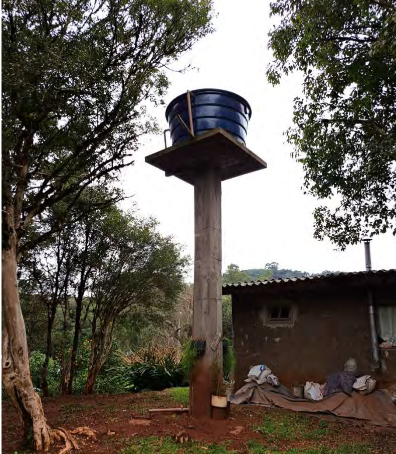
Figura 145: Centro de reservação do SAA Papuã - PRFV 2,5 m 3 - 07/2024.
