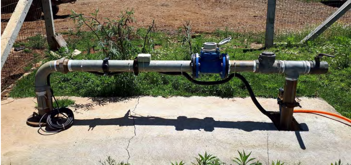
Figura 116: Cavalete P16 – Poço Aparício 02 - 10/2022.
