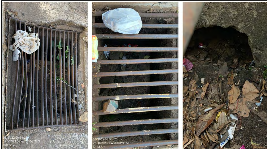
Figura 291: Falta de manutenção das bocas de lobo – 08/2022.
