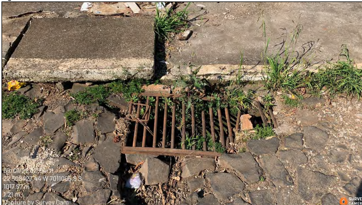
Figura 267: Boca de lobo danificada e com acúmulo de sedimentos – 09/2022.
