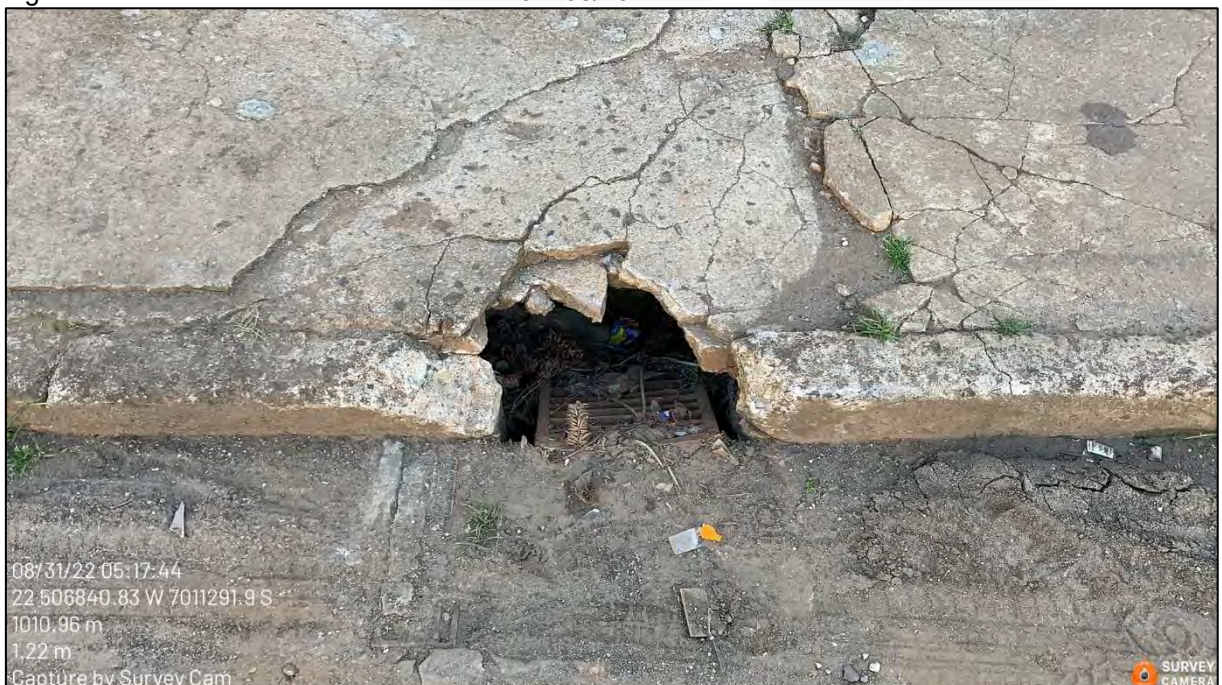
Figura 271: Boca de lobo danificada na AP-9 – 08/2022.
