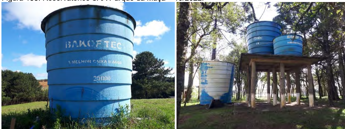
Figura 153: Reservatórios SAA Parque da Maçã – 10/2022.
