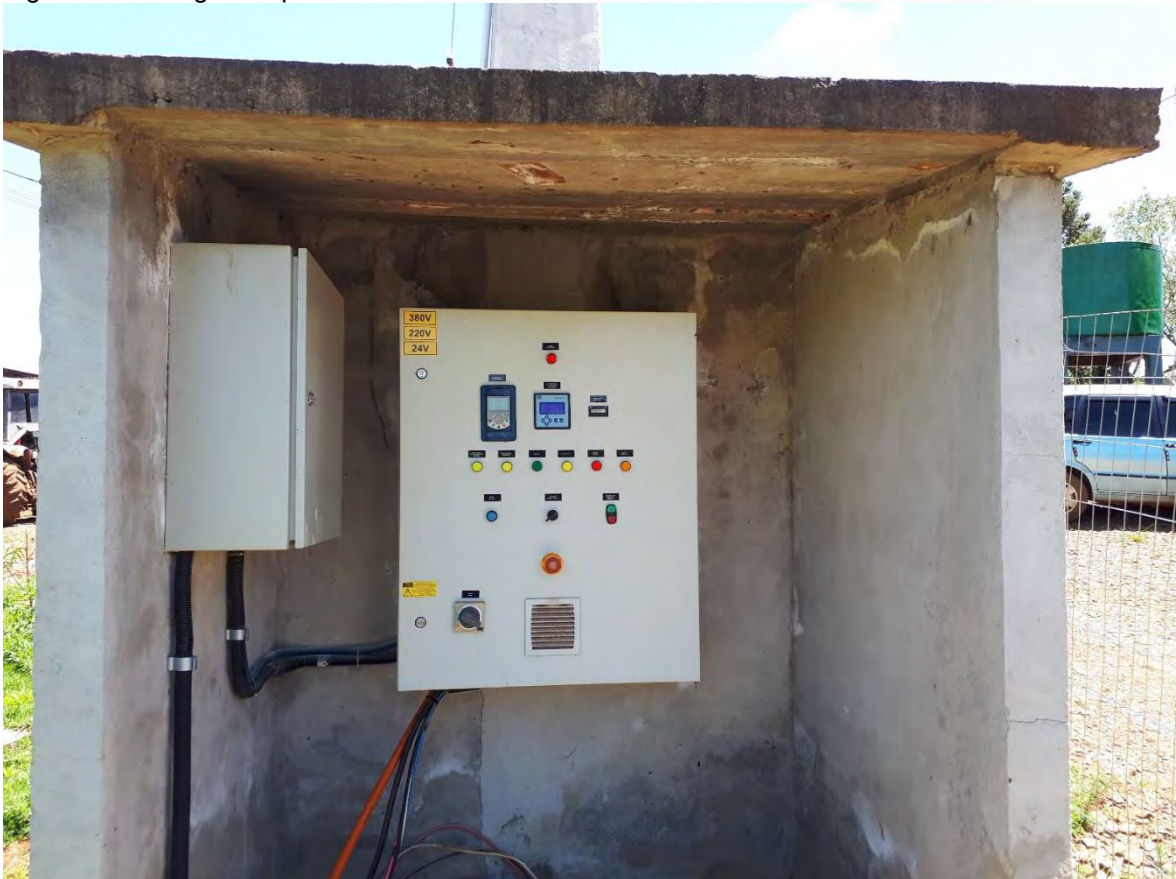
Figura 117: Abrigo dos painéis de comando e telemetria do P16 - 10/2022.
