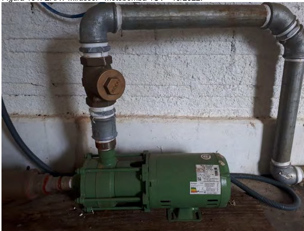
Figura 101: ERAT Mirassol - motobomba 1CV -10/2022.
