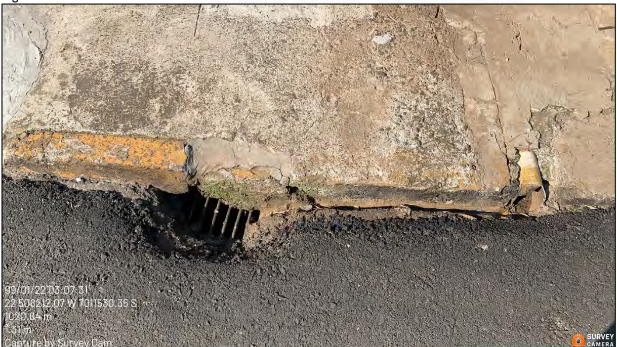
Figura 279: Boca de lobo subdimensionada – 09/2022.
