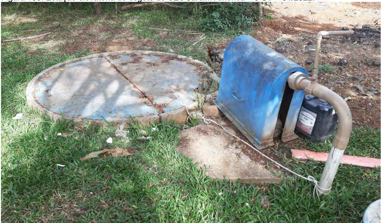
Figura 159: Estação elevatória de esgoto do SES Jardim América – 5 CV – 01/2022.
