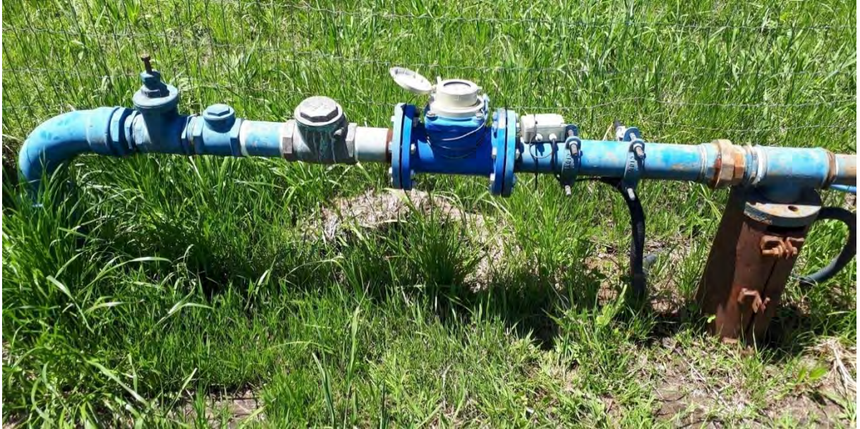
Figura 113: Cavalete P10 – Poço Aparício 01 - 10/2022.
