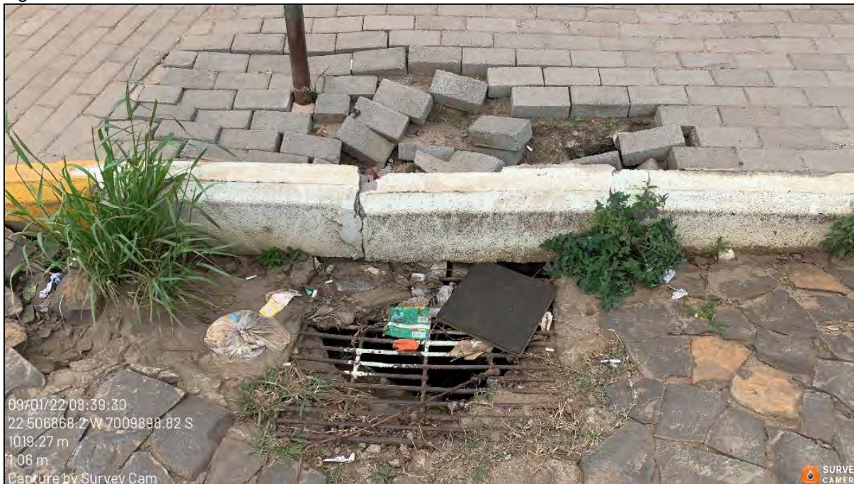
Figura 250: Boca de lobo danificada - AP4 – 09/2022.
