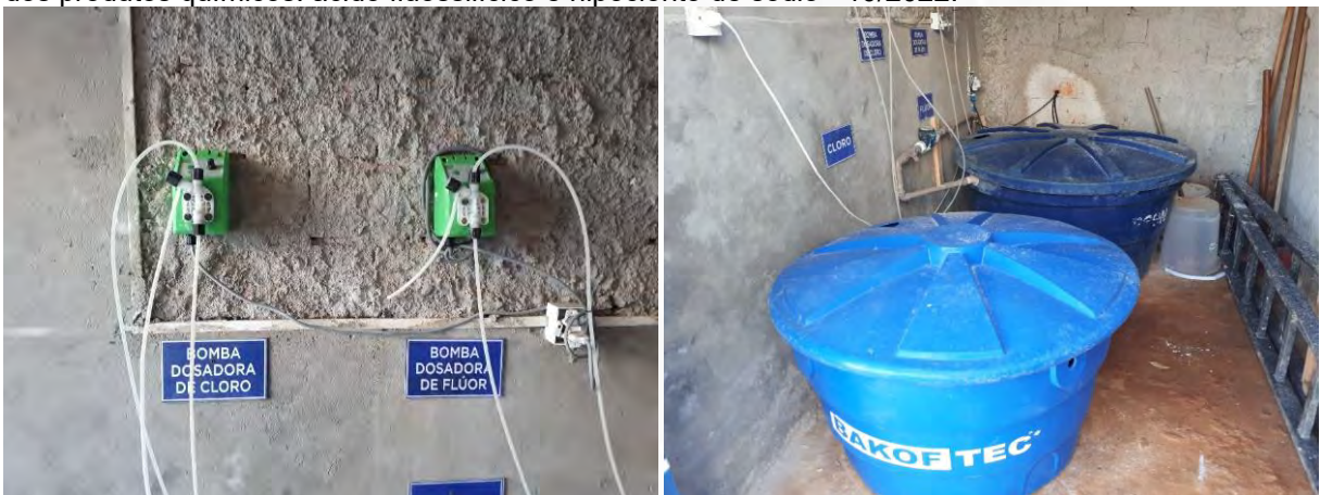
Figura 111: UTS Centro de reservação São Miguel – Bombas dosadoras e tanques de armazenamento dos produtos químicos: ácido fluossilcico e hipoclorito de sódio - 10/2022.
