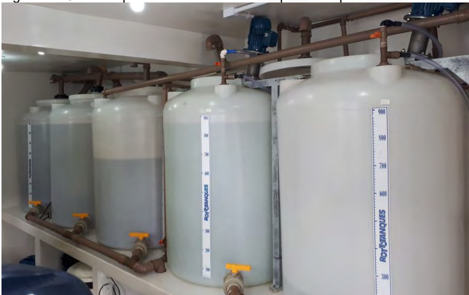
Figura 42: Casa de química – Armazenamento produtos químicos – Sulfato de Alumínio -10/2022.
