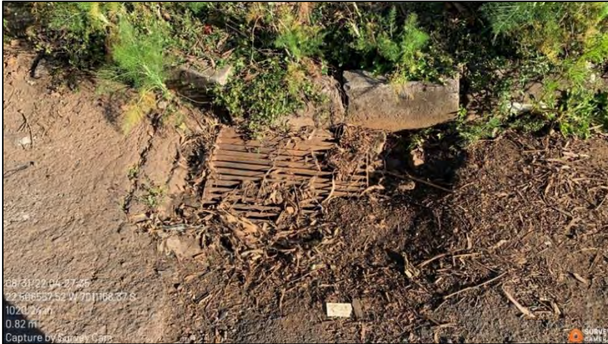
Figura 289: Falta de manutenção verificada na boca de lobo – 08/2022.
