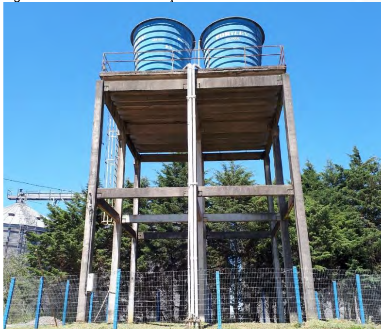
Figura 95: Centro de reservação Portal - 4x20 m³ em PRFV – 10/2022.
