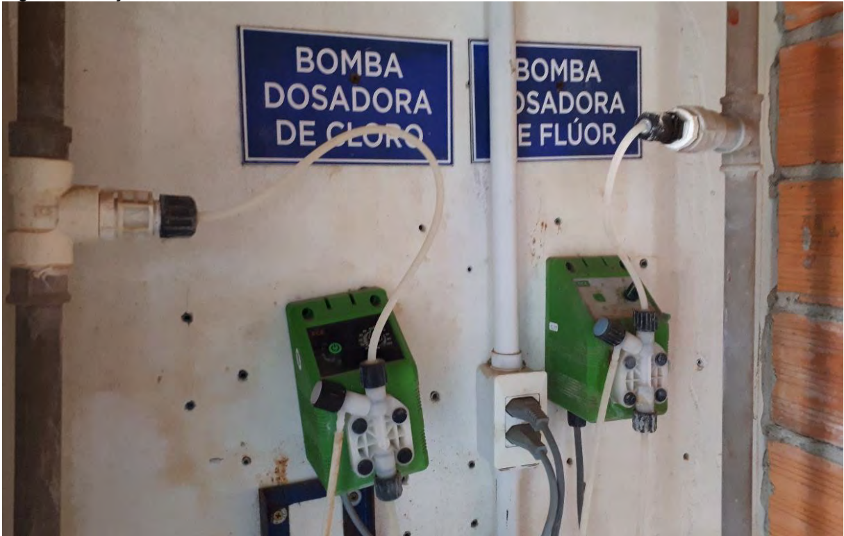
Figura 73: Poço P09 – Bombas dosadoras -10/2022.
