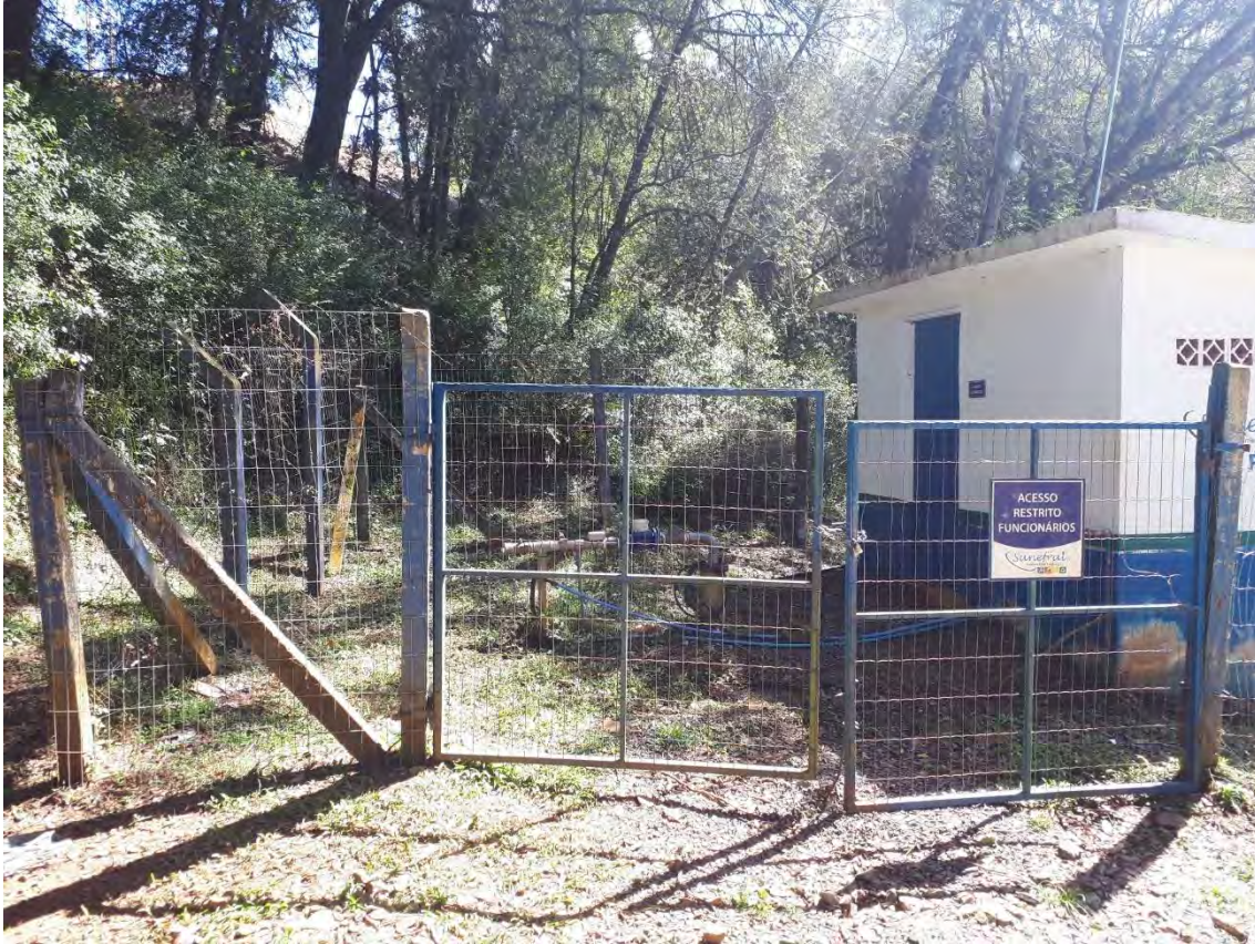
Figura 132: Visão geral da captação P06 – Poço São Luís - 10/2022.
