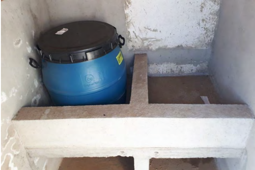
Figura 75: Poço P09 - Novo sala para armazenamento dos químicos da UTS -10/2022.
