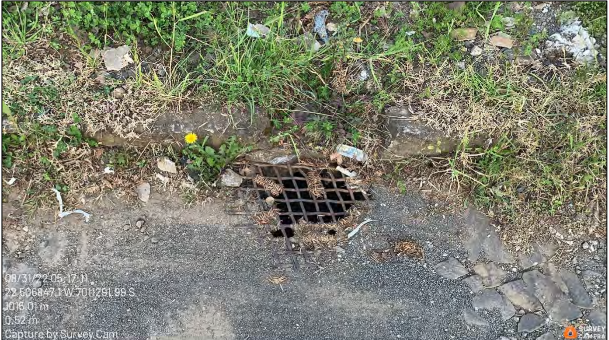
Figura 234: Modelo de grelha de boca de lobo existente no município (Rua Felisbino Pedroso).
