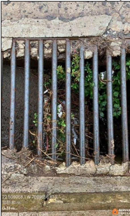
Figura 320: Crescimento de vegetação no interior da boca de lobo – 09/2022.
