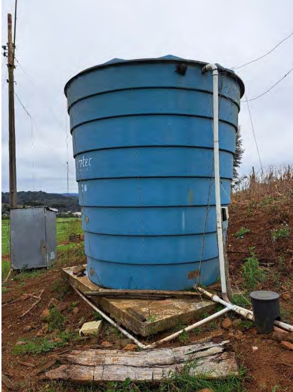
Figura 142: Centro de reservação do SAA Faxinal dos Carvalhos - PRFV 20 m 3 - 07/2024.
