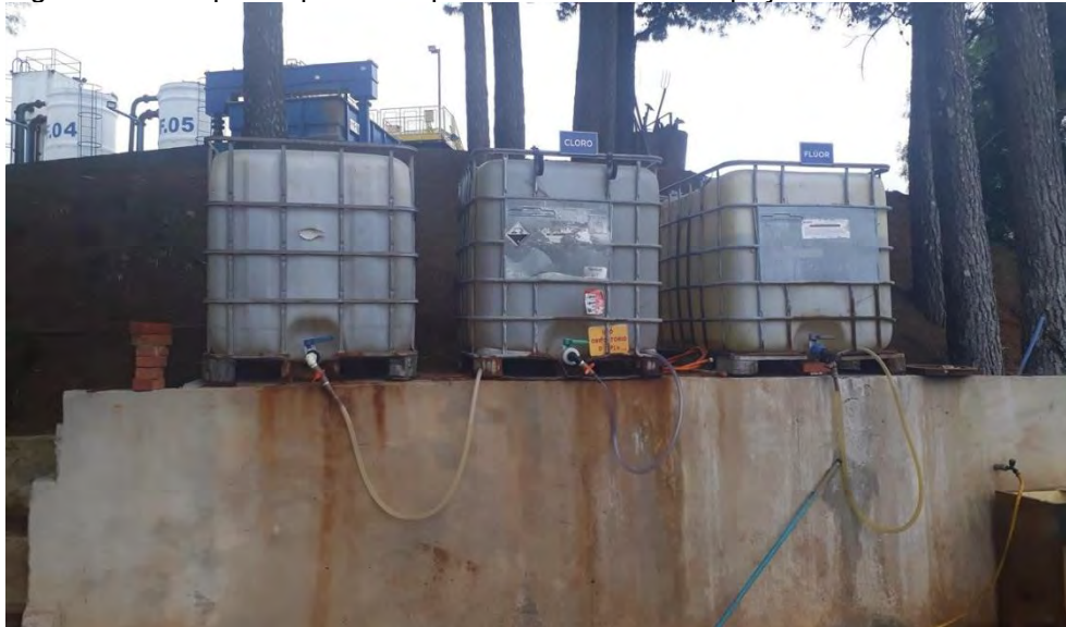
Figura 46: Estoque de produtos químicos utilizados nos poços.
