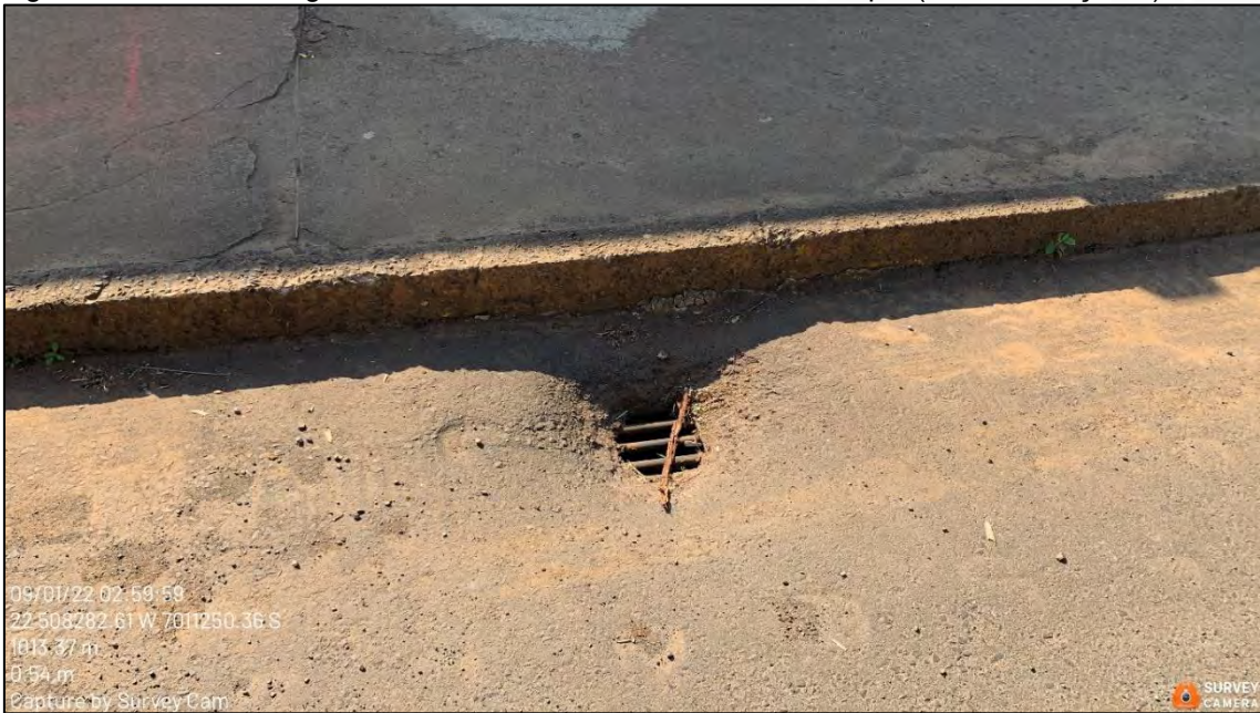
Figura 232: Modelo de grelha de boca de lobo existente no município (Avenida Caçador).
