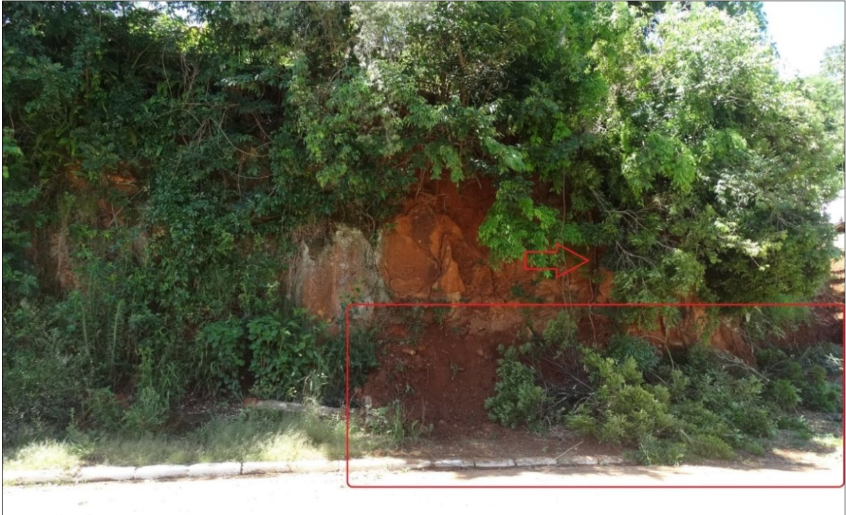
Figura 31 - Região que apresentou deslizamento de terra e queda de árvores. A seta vermelha indica que outras árvores estão perdendo sua sustentação por causa do corte feito no talude.
