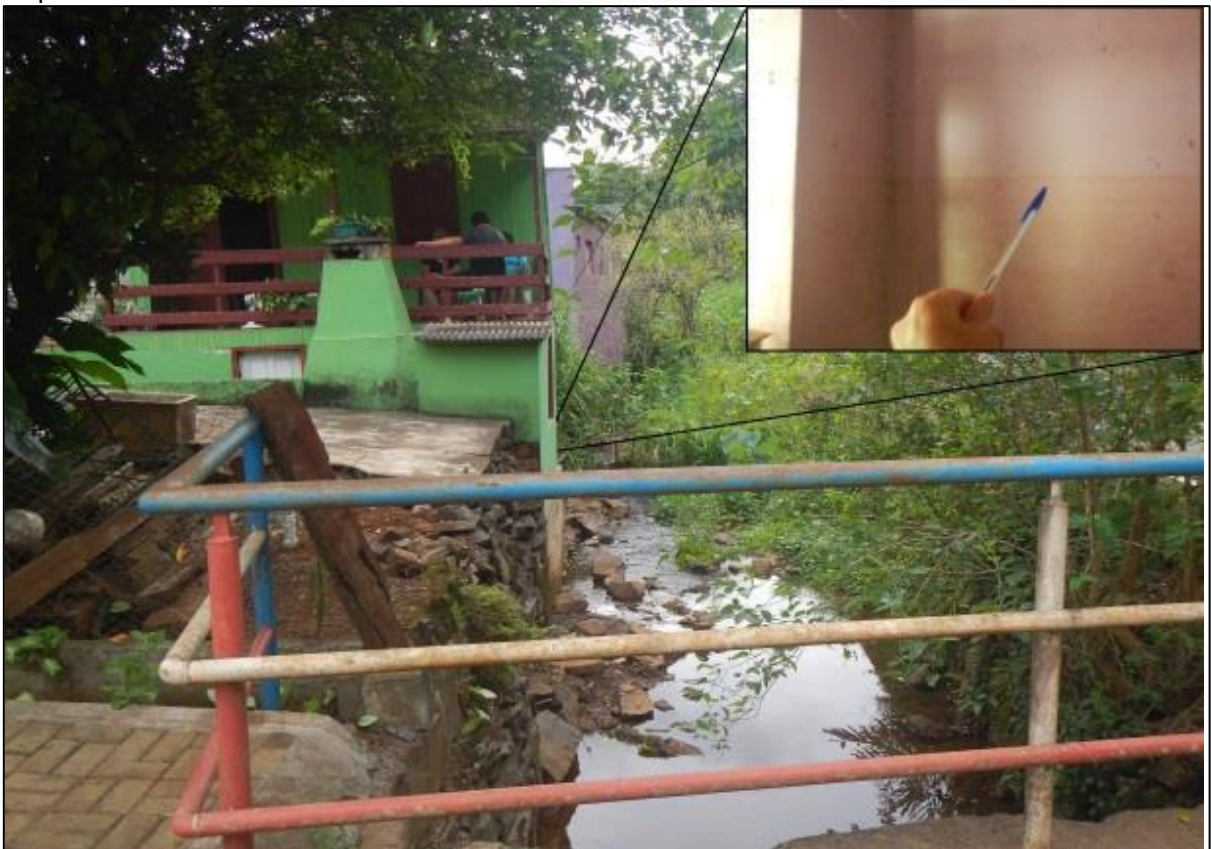
Figura 40 - Casa construída praticamente sobre o Arroio da Vila, no detalhe as marcas da última cheia na parte inferior da moradia
