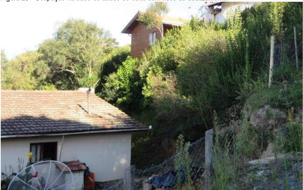
Figura 28 - Ocupação na base de talude de corte com risco de deslizamento.
