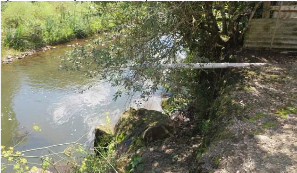
Figura 7 - Erosão na margem do Rio Urubici avançou 8 metros em 9 anos.
