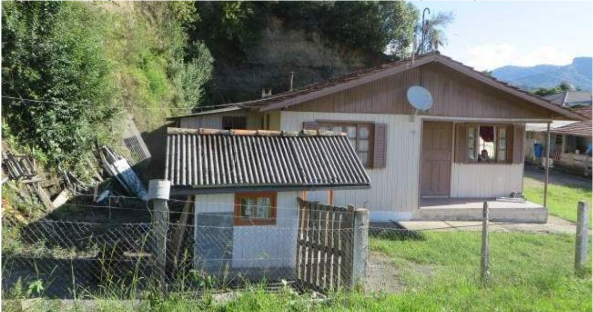
Figura 27 - Ocupação na base de talude de corte com ocorrência de pequenas rupturas no talude.
