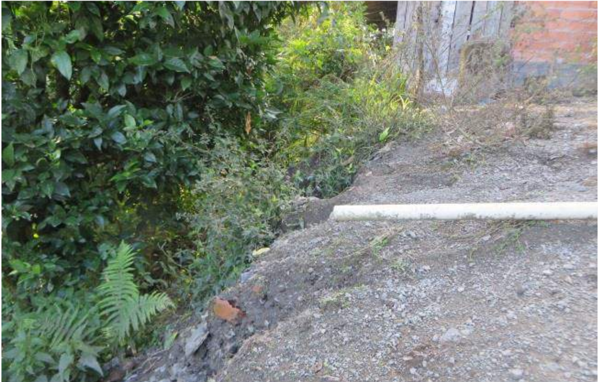
Figura 25 - Lançamento de águas servidas sobre a encosta do rio potencializa o risco de ocorrência de movimentos de massa.
