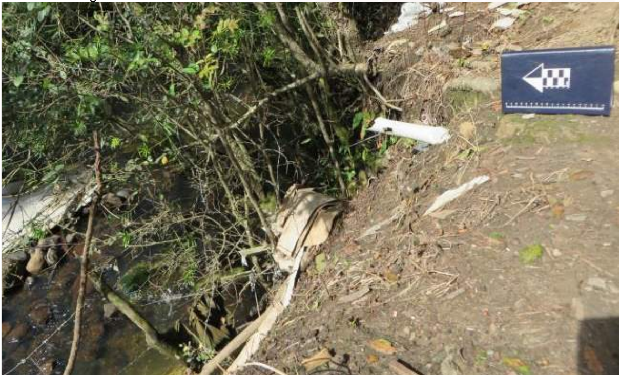
Figura 12 - Árvores inclinadas e trincas no terreno na margem do Rio do Riacho com ocorrência de erosão de margem fluvial.
