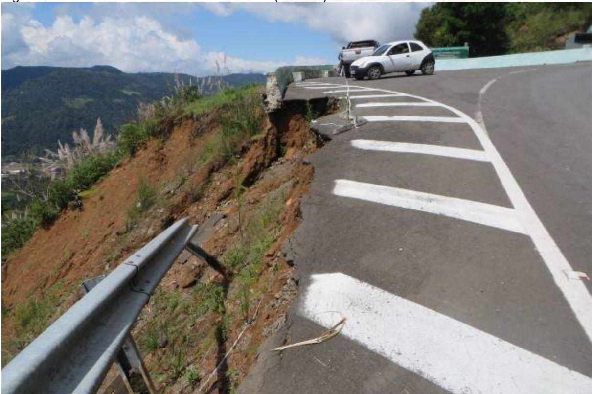
Figura 31 – Deslizamento no aterro da rodovia (SC-110) em área turística.
