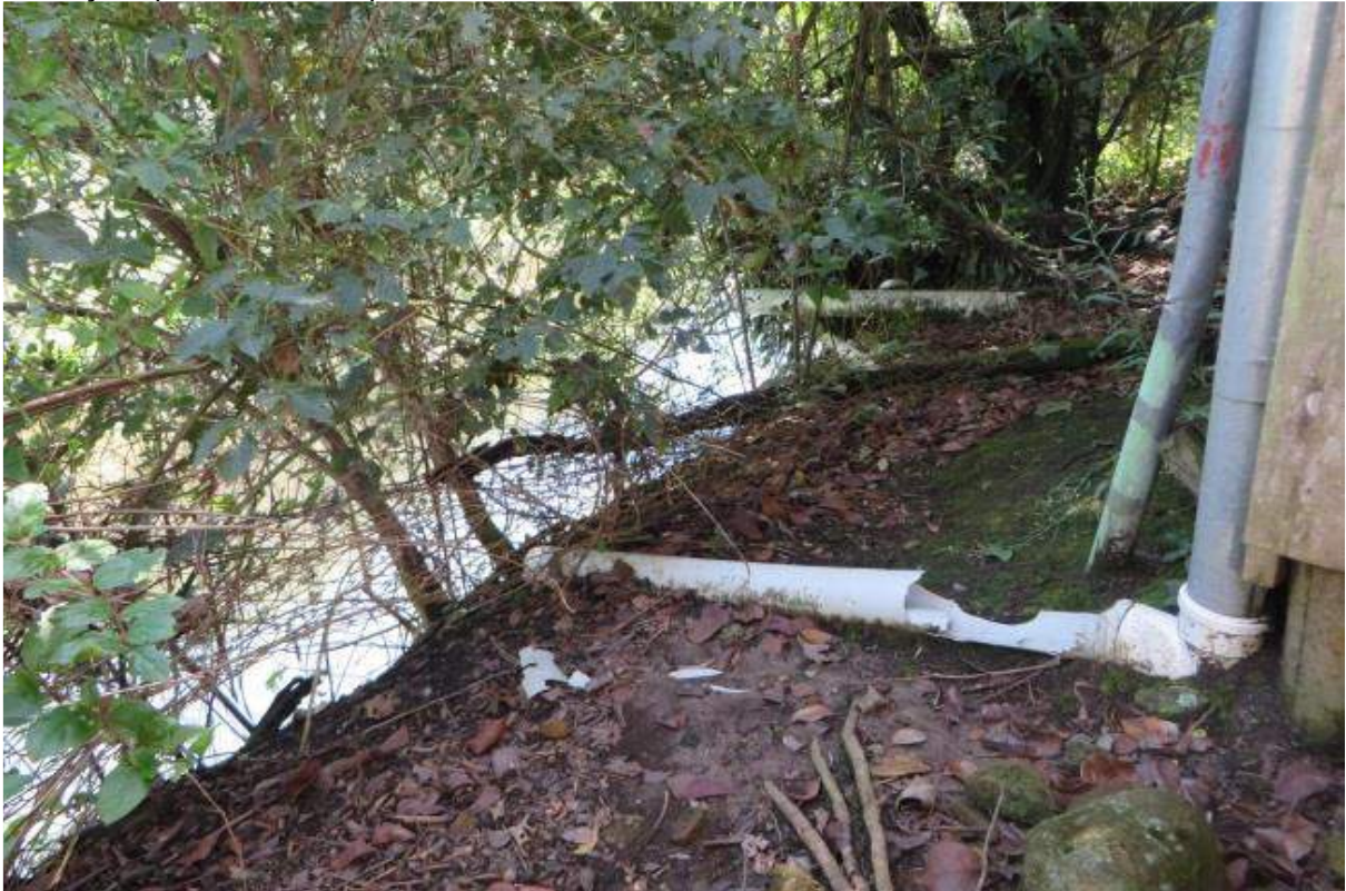
Figura 8 - Árvores inclinadas são indícios de instabilidade na margem do rio Urubici. Vazamentos nas tubulações potencializam o processo.
