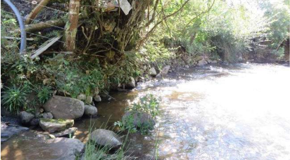
Figura 11 - Rio do Riacho em ponto de erosão de margem fluvial.
